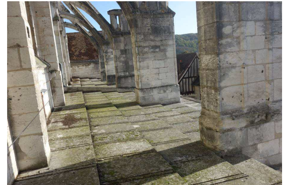
Figure 33 - Colonisation biologique sur la terrasse sud
