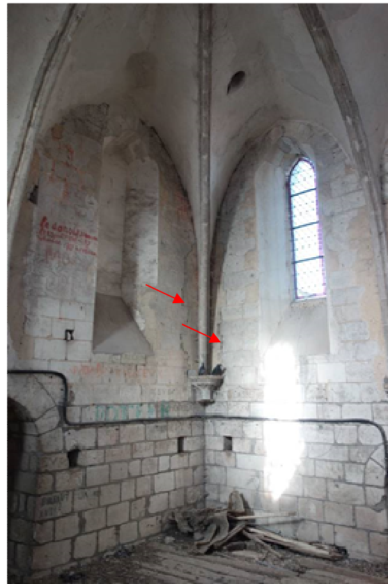
Figure 76 - Chapelle haute ; fissuration du mur le long d'une arête.
