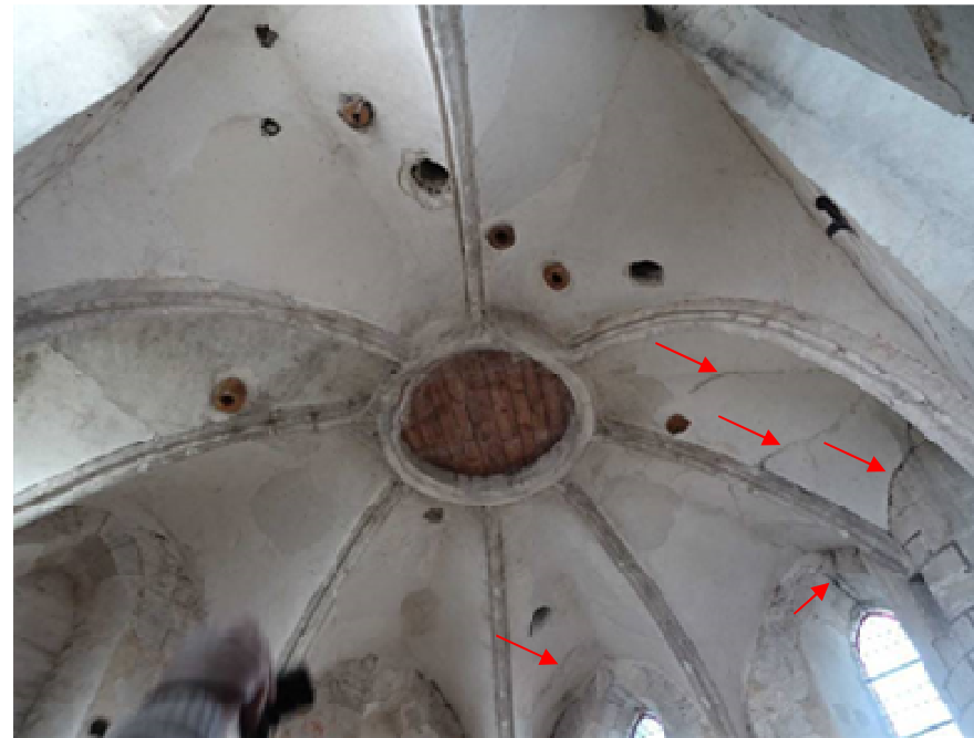
Figure 77 - Chapelle haute ; fissures dans les voûtains, décollement entre un voûtain et le mur, dite fissure "de Sabouret", au droit des baies.
