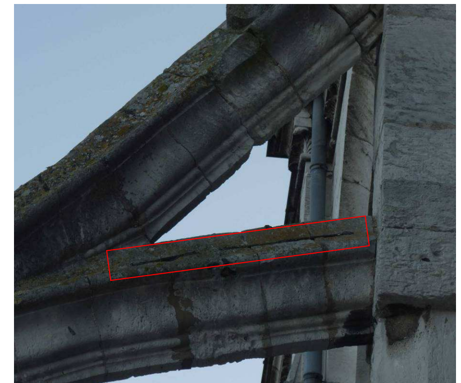
Figure 18 - Arc-boutant 3. Détail sur renforcement métallique (agrafe ?)
