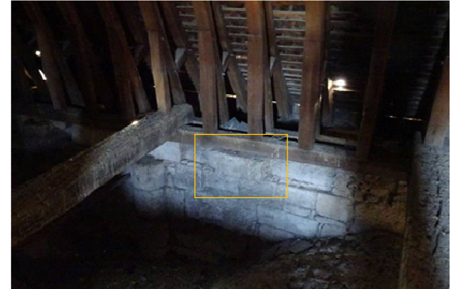
Figure 66 - File 6, Sud, bloc désolidarisé
