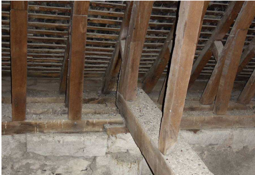
Figure 58 - Ferme primaire 5a, Sud, panne sablière discontinue.
