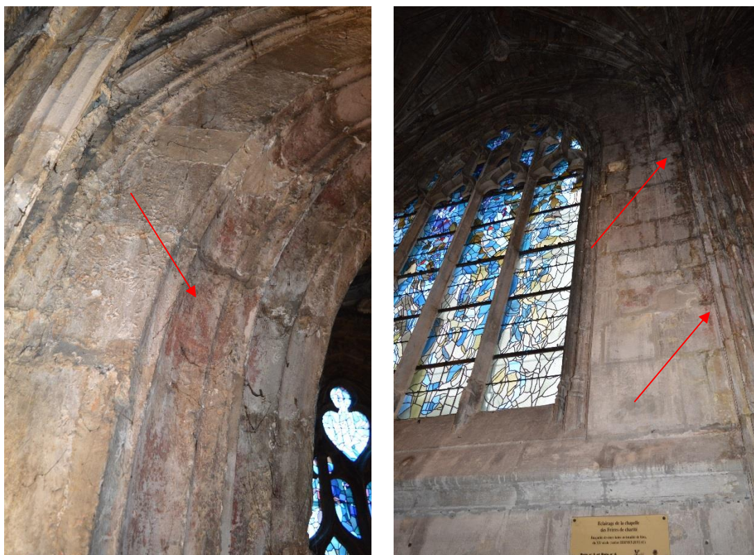
Vue générale de vestiges de badigeon rouge sur les parements, nervure et arc des travées du bas-côté nord adjacentes à la chapelle des frères de la Charité
