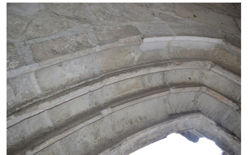
Vue des voissures depuis l'intérieur du porche avec des changements de pierre
