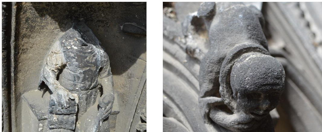
Encrassement noir correspondant à des dépôts atmosphériques affectant les surfaces des décors
