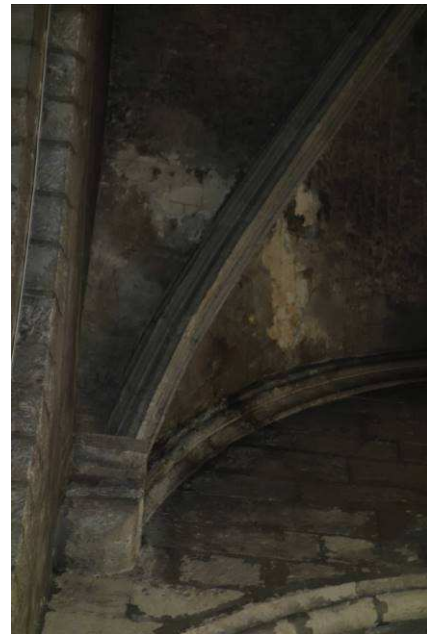
Figure 44 - Bras Sud du transept, naissance de la voûte ; traces d'infiltrations.
