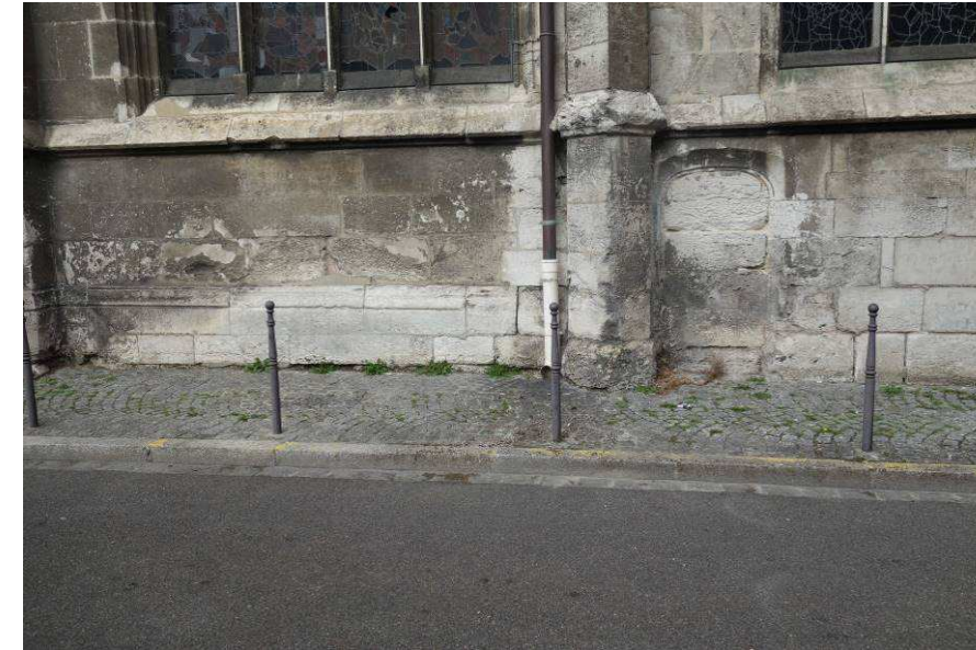
Figure 11 - Elévation Sud ; traces d'infiltration, alvéolisation, déjoints ; descente des eaux en pied de mur.
