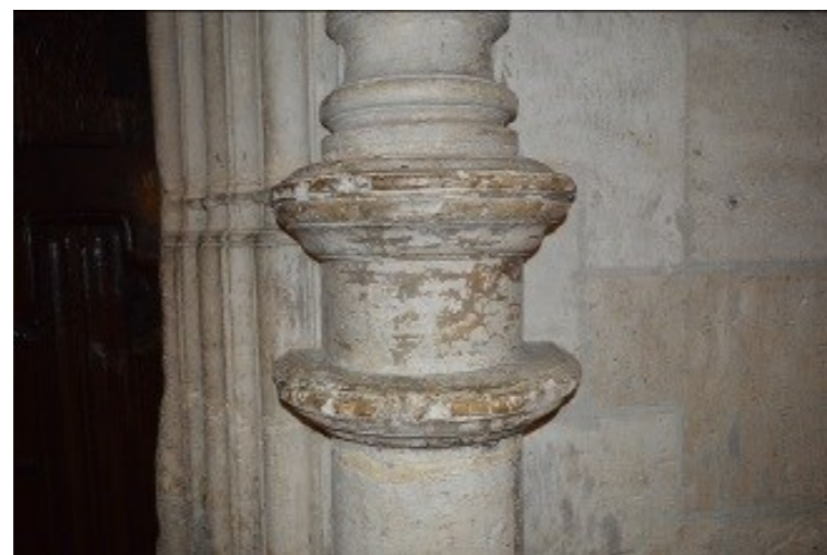
Vestige d'un ancien traitement de surface ou d'un badigeon ocre sur le portail renaissance
