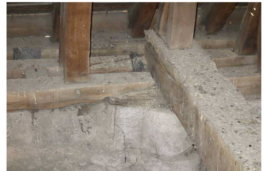
Figure 57 - Ferme principale 3a, Sud, panne sablière endommagée.
