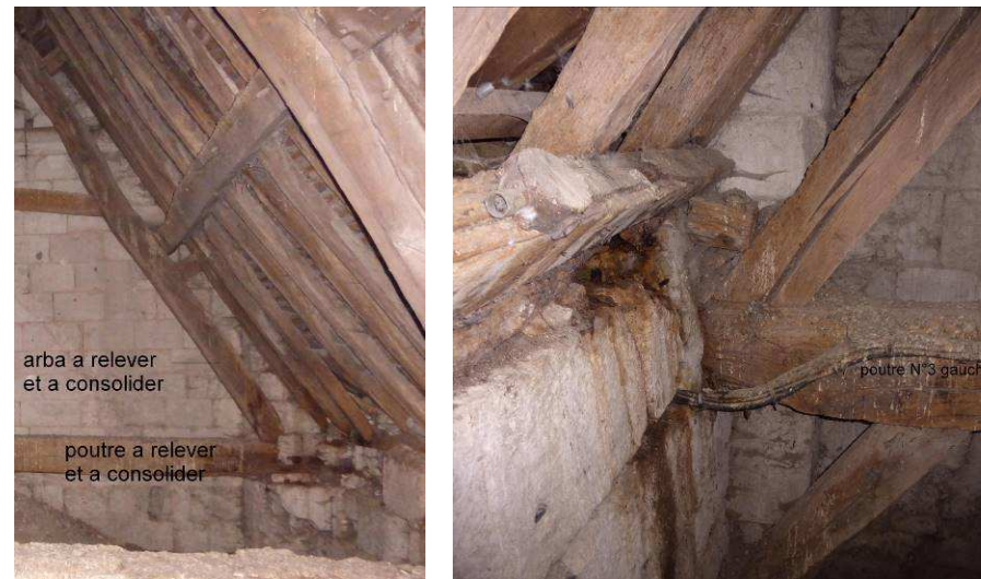
Figures 71 (a et b) – Etat de dégradation extrêmement prononcé des pieds de la ferme Sud avant renforcement – Clichés transmis par l'architecte
