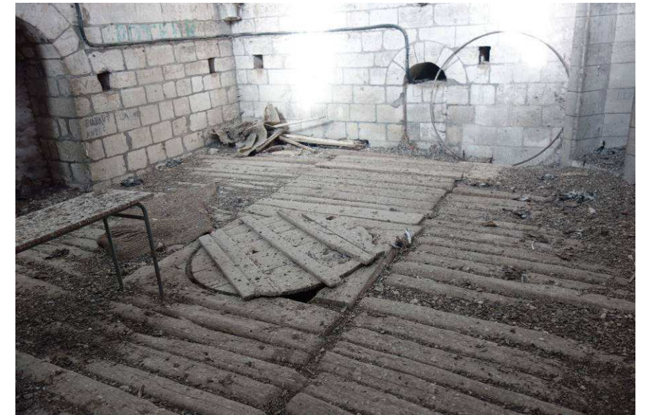
Figure 78 - Chapelle haute ; plancher envahi de fientes d'oiseaux.
