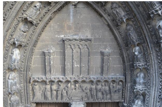
Encrassement généralisé des surfaces du portail occidental
