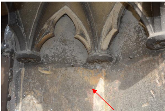
Vestiges de badigeon ocre jaune au droit des jambages intérieurs latéraux
