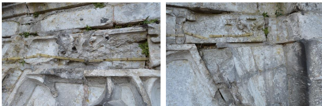
Exemples d'éléments désorganisés identifiés en partie haute du portail extérieur Nord
