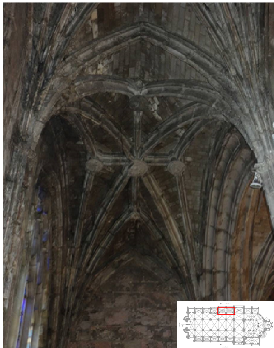
Figure 50 - Bas-côté Nord, chapelle des Frères de Charité ; Infiltrations.
