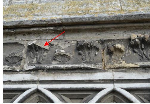
Exemple de lacune liée à une érosion avancée par lessivage
