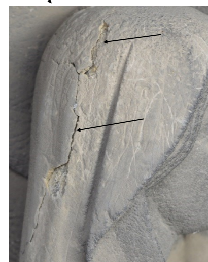
Décor sculpté fissuré au droit du linteau
