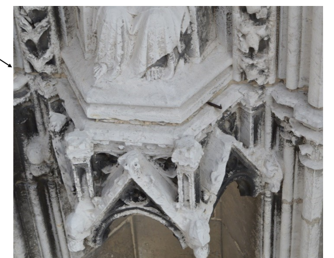
Zone exposée et lessivée
