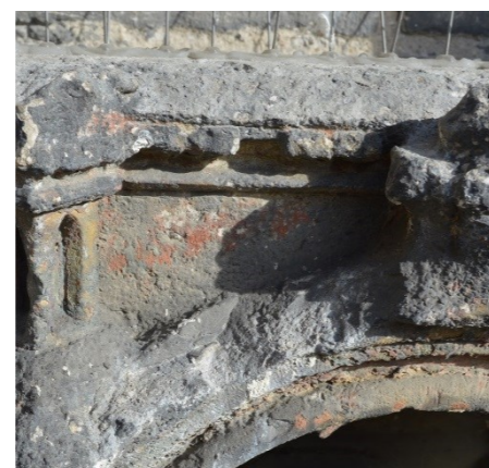
Vestige de badigeon coloré sur la frise au-dessus du linteau
