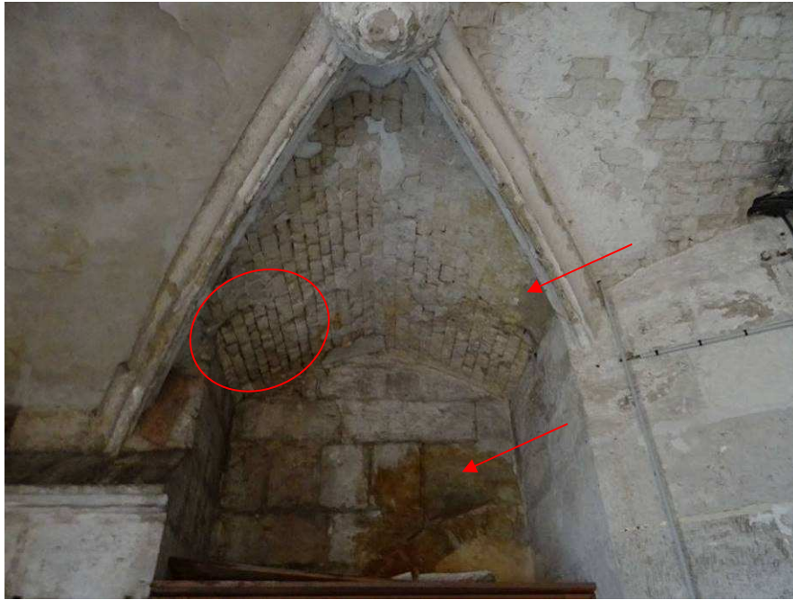
Figure 53 - Sacristie haute ; infiltrations, déjointoiment.
