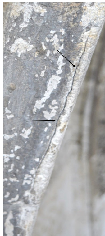
Fissure susceptible d'évoluer en détachement en bordure de l'arc
