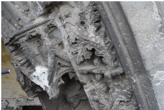
Encrassement épais identifié au droit des décor du portail extérieur Nord
