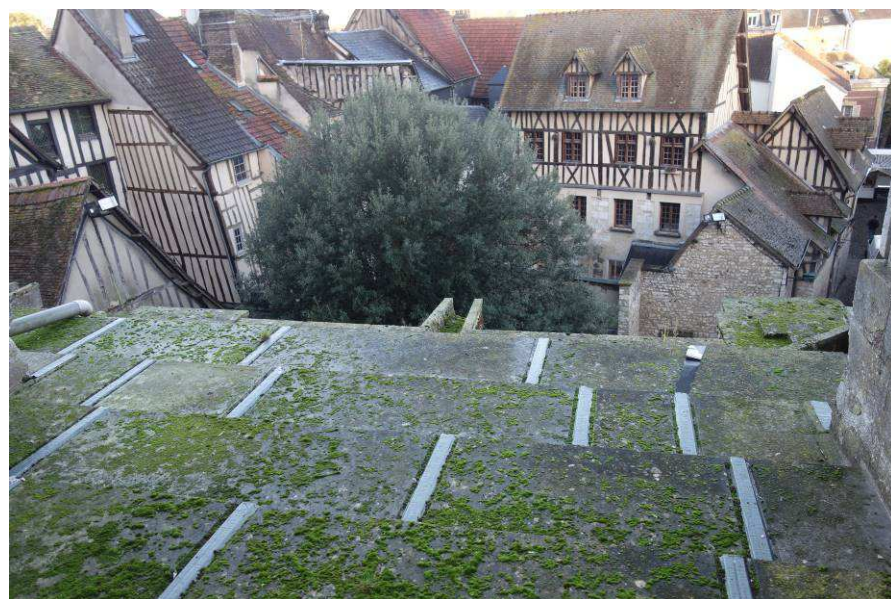
Figure 26 – Importante colonisation biologique sur la terrasse nord
