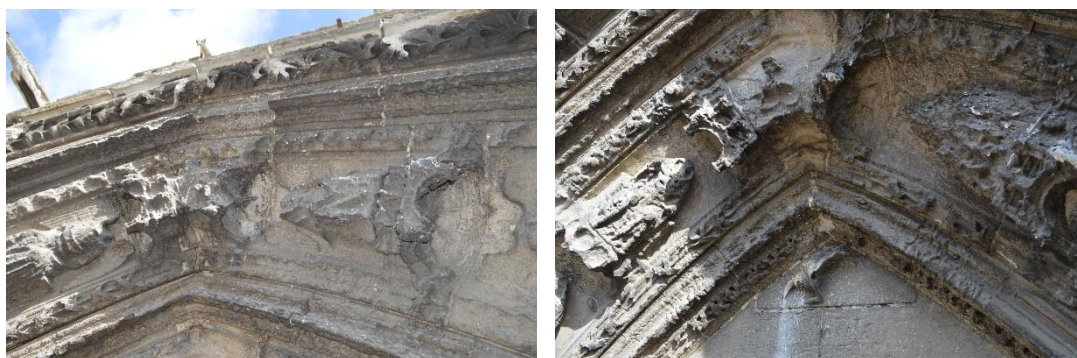
Voussures hautes affectée par une érosion profonde et l'alvéolisation de la pierre
