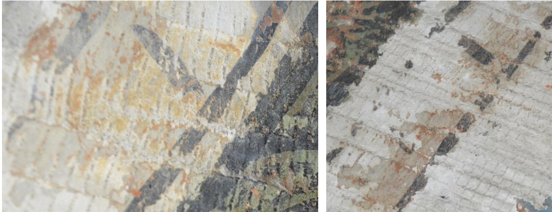
Écailles jaunes et gris-beige observables au droit du losange ; on note ici clairement l'aspect de surface de la pierre visiblement retaillé au chemin de fer sur lequel la peinture pour les blasons a été appliquée
