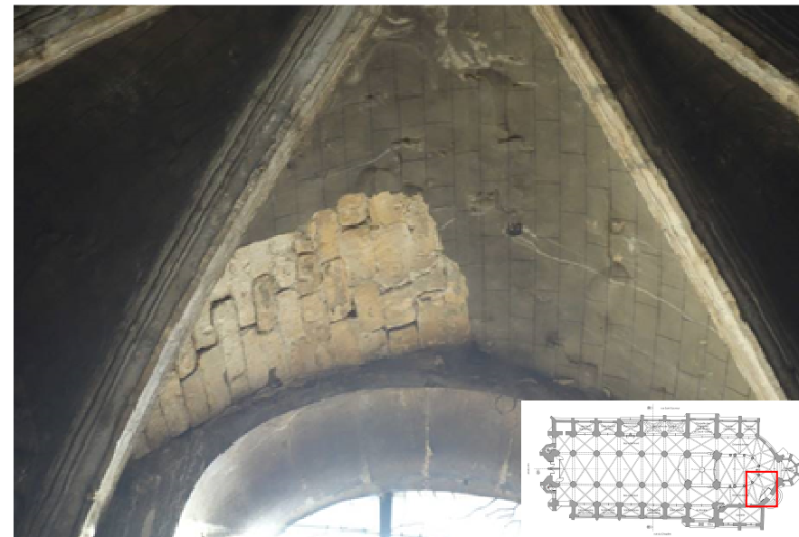
Figure 45 - Déambulatoire ; fissuration et lessivage très prononcés des maçonneries du quartier de voutain
