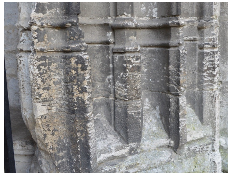
Desquamations en partie basse du pilier
