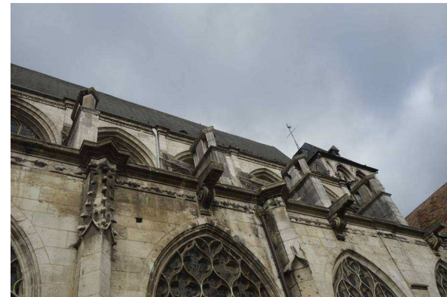
Figure 12 - Elévation Sud ; coulures en tête de mur.
