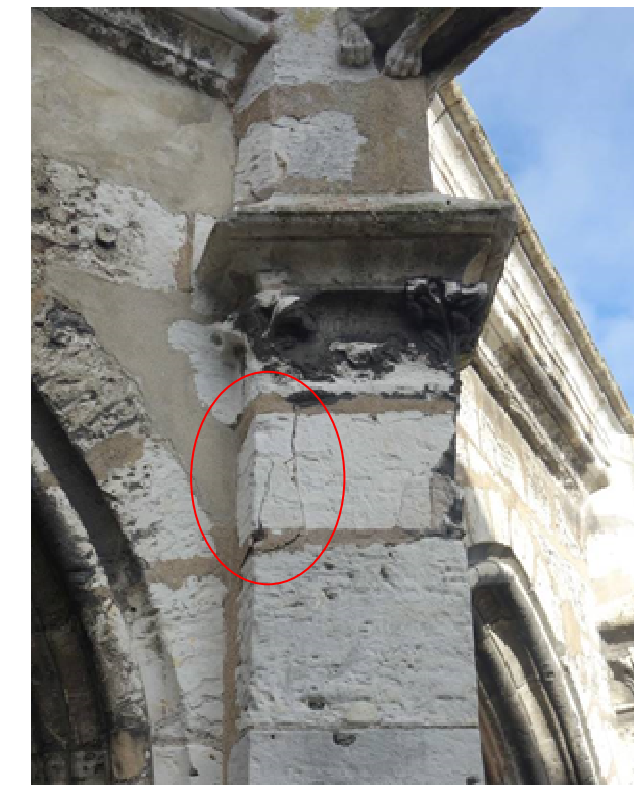
Figure 39 - Terrasse du chevet. Exemple de pierre fissurée
