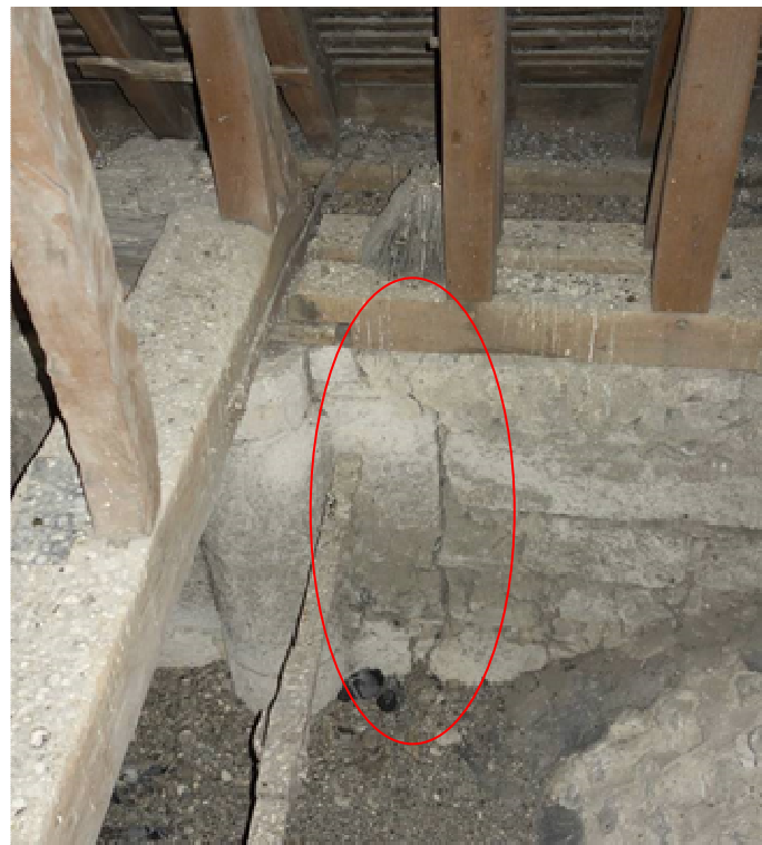
Figure 63 - File 5, Nord, fissure verticale sur le mur gouttereau au droit du piédroit
