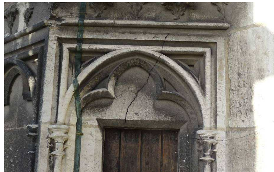
Figure 32 - Linteau fissuré de la porte de l'escalier
