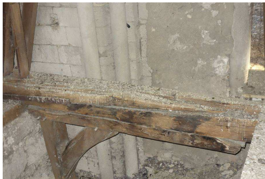
Figure 59 - Ferme primaire 7, entrain très endommagé - échauffement très prononcé)
