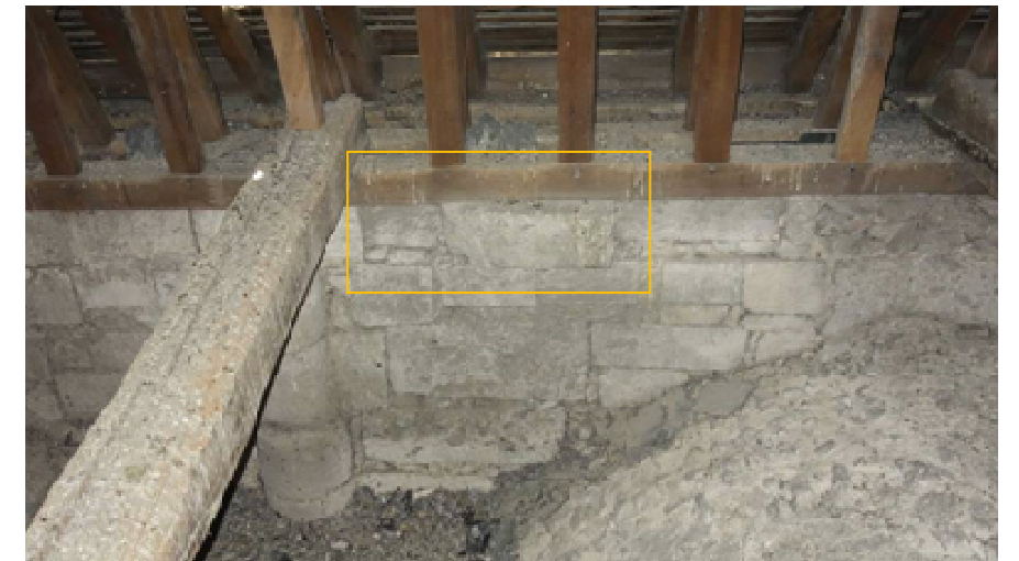
Figure 67 - File 6, Sud, bloc désolidarisé et bloc manquant
