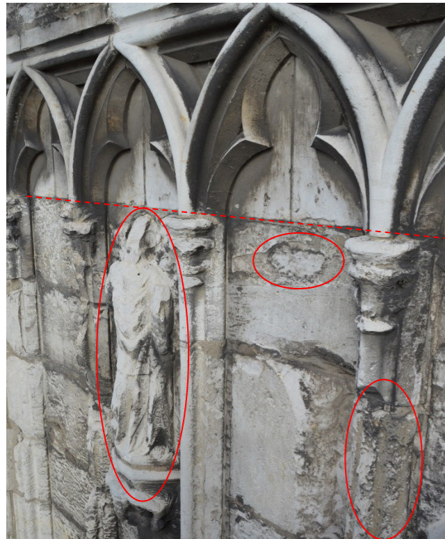
Zone présentant des lacunes et des desquamations liées à d'anciennes dégradations partiellement stabilisées, en dessous de la rangée de pierres remplacées
