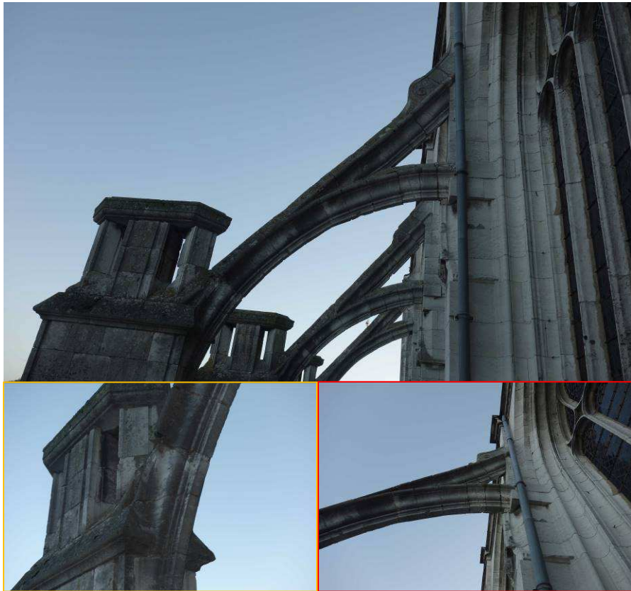
Figure 19 - Arc-boutant 4. Affaissement d'un claveau, rejointoiement en ciment, dégradation de la naissance de voûte.
