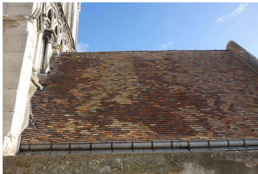
Figure 36 - Couverture de la sacristie, désorganisation des tuiles.
