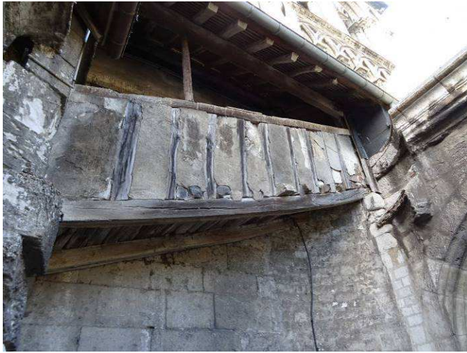
Figure 40 - Passerelle d'accès à la tour du clocher. Bois échauffé
