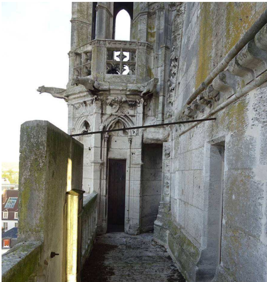
Figure 75 - Balcon entre les clochetons ; tirant métallique entre le mur de façade et la tête du mur du porche.
