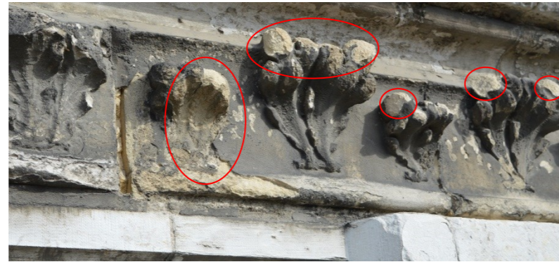
Frise sculptée présentant un important encroûtement noir ainsi que des desquamations dans les zones exposées
