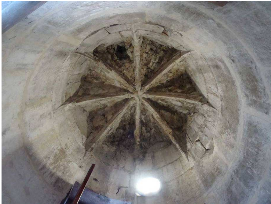
Figure 74 – Tour d'escalier à vis Nord donnant accès à la terrasse occidentale supérieure; infiltrations dans la voûte, fissures, déjointement.
