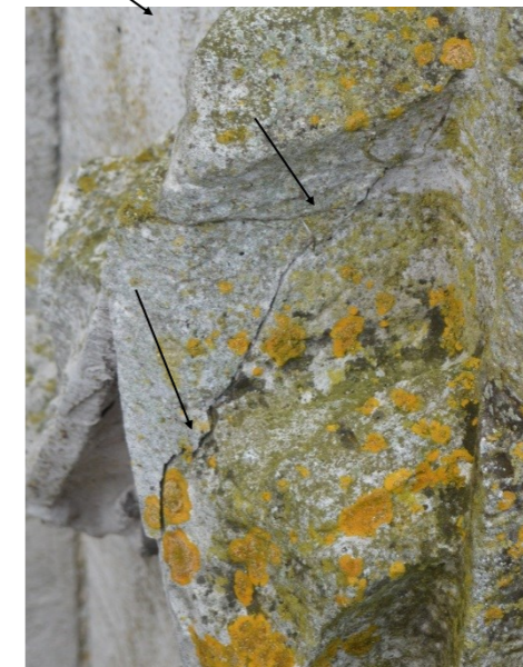
Fissure et développements biologiques (lichens) au droit du dais
