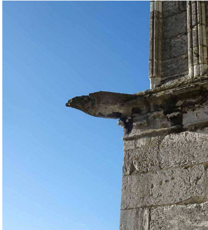
Figure 25 - Terrasse du bas-côté Sud. Exemple de détachement
