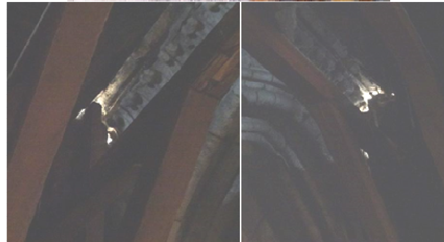
Figures 60 (a, b et c) - Défaut d'étanchéité de la couverture à l'interface entre la couverture du vaisseau central et des maçonneries de la tour-clocher
