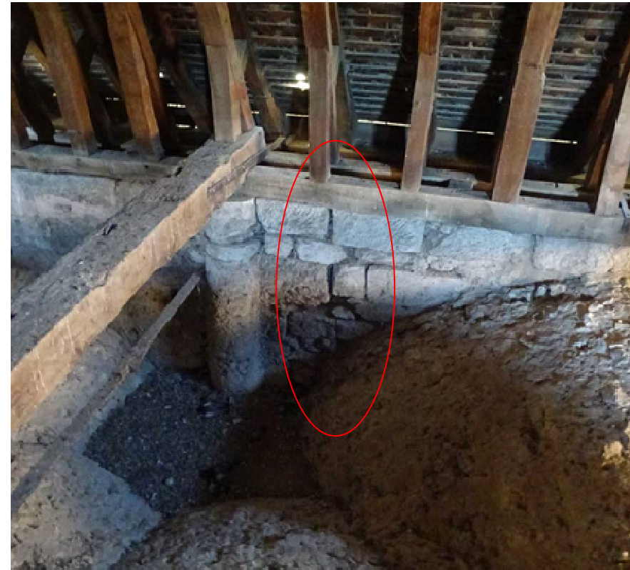
Figure 64 - File 3, Sud, fissure verticale sur le mur gouttereau au droit du piédroit et désorganisation localisée des maçonneries
