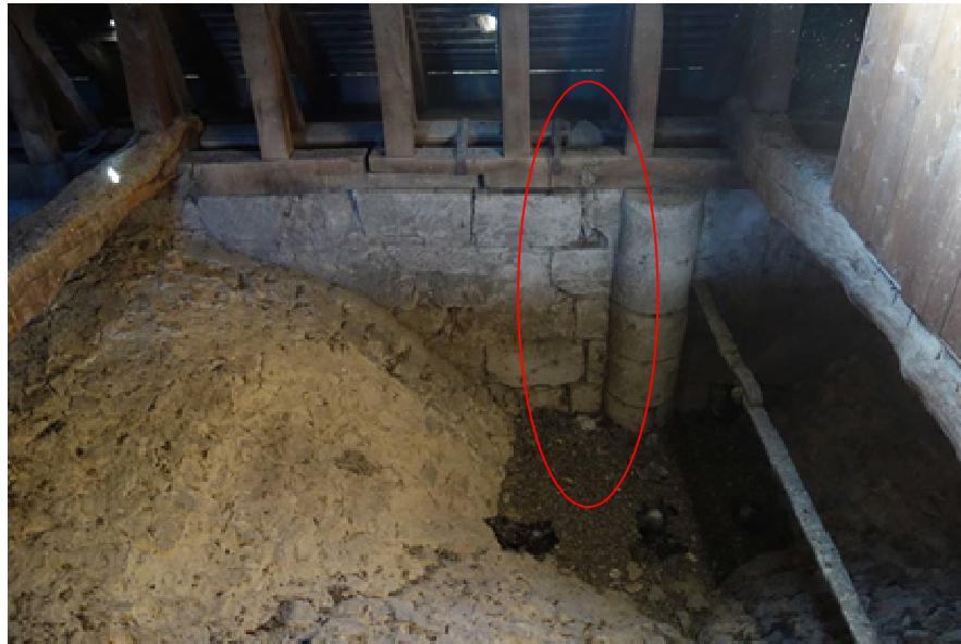
Figure 62 - File 1, Sud, fissure verticale sur le mur gouttereau au droit du piédroit
