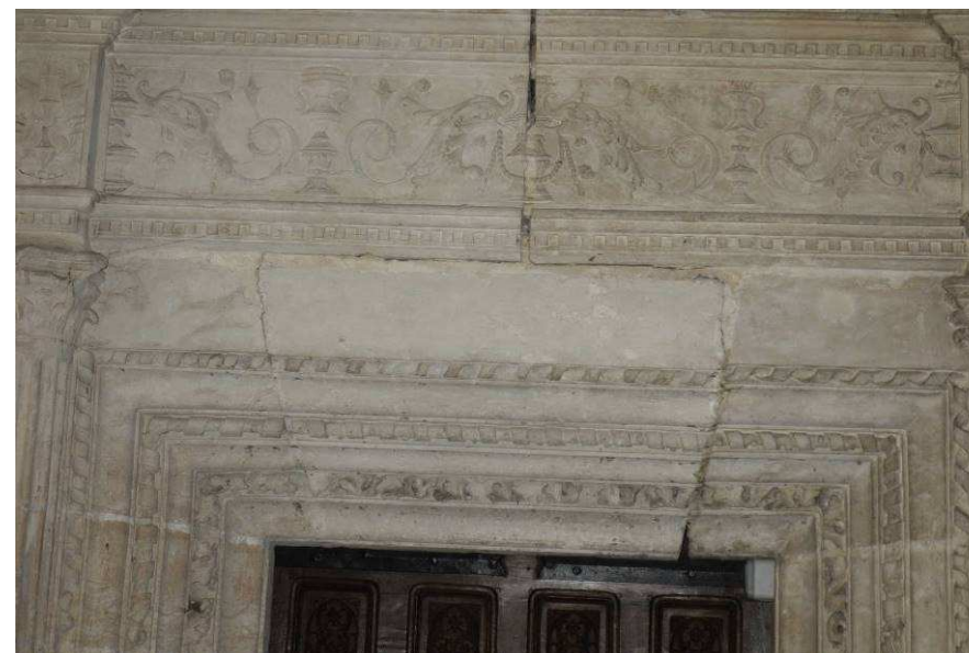
Figure 46 - Déambulatoire, porte de la sacristie ; fissuration au droit de la plate-bande et déchaussement du claveau de clef
