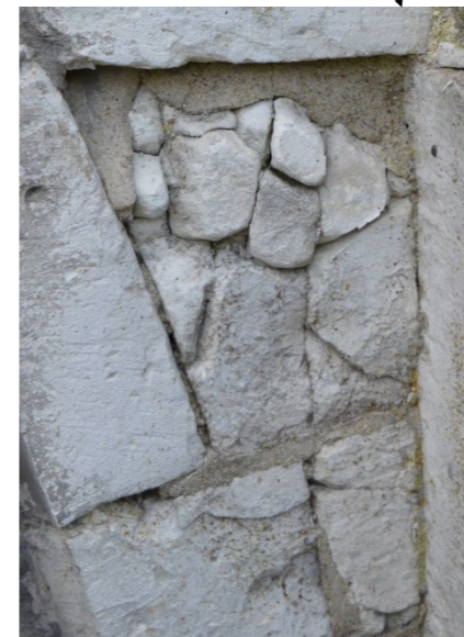
Assise fracturée au dessus de la ligne d'imposte de l'arc
