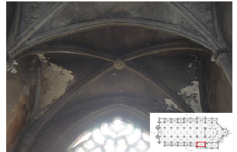
Figure 42 - Chapelle du Rosaire ; traces d'infiltration (principalement au niveau des naissances de voûte)
