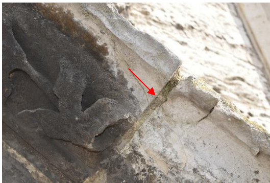
Exemple de joint pulvérulent dégarni identifié au droit du portail occidental
