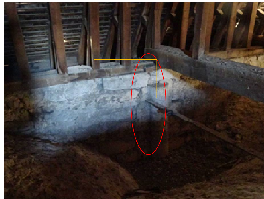
Figure 65 - File 5, Sud, fissure verticale et bloc désolidarisé
