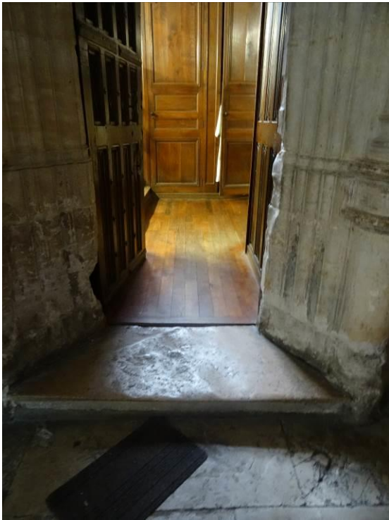
221. Accès à la sacristie : dégradation des moulures et parements altérés au droit de l'encadrement de porte.
