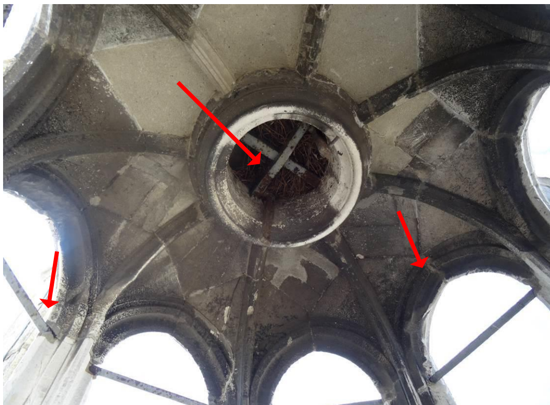
18. Détail de la voûte au sommet de la tourelle Sud : éclatement des pierres sous l'effet de la corrosion des armatures métalliques, joints dégradés, extradados de voûte colonisé par des oiseaux.
