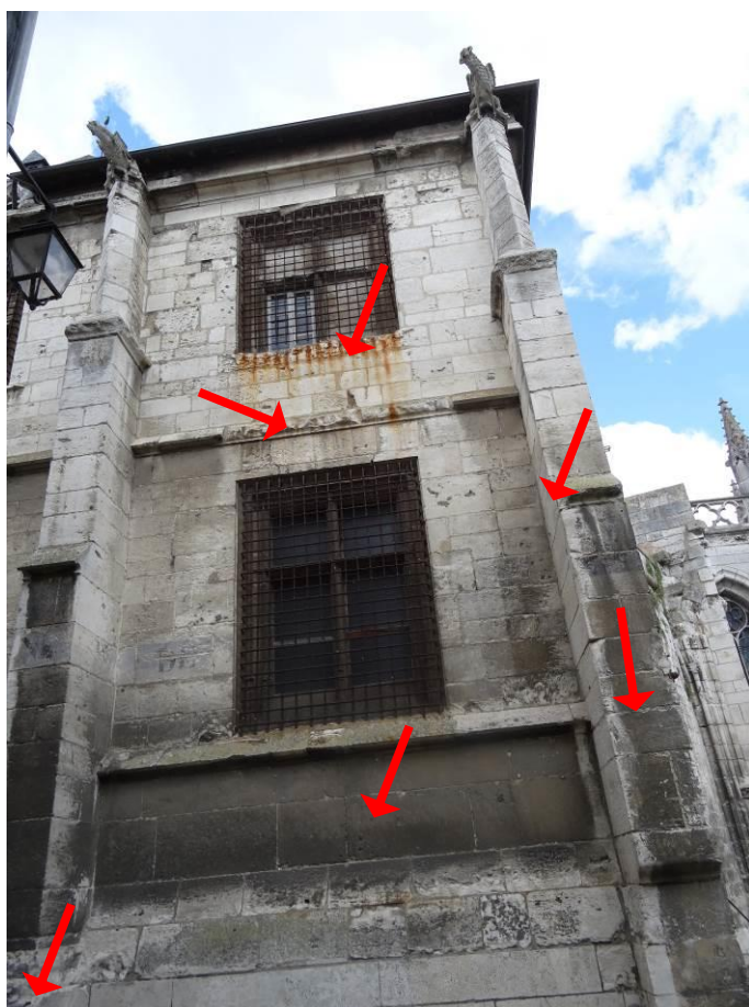
55. Encrassement et dégradation des parements au droit du soubassement, bandeau très érodé, coulure de rouille au droit de la grille corrodée sur façade, surface de croisée étage bouchée, encrassement et larmier cassé du contrefort.
