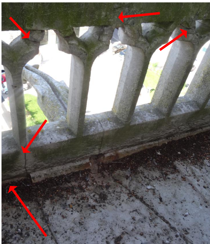
14. Détail de la balustrade de la galerie haute : joints ouverts entre les balustres, dégradation de la bande soline entre le sol et la balustrade, présence de fientes de pigeons et rongeurs, altération et développement de micro-végétation sur les balustres.
