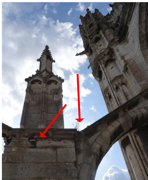
97. 1 er contrefort et arc-boutant Nord : encrassement généralisé, développement de végétation.
