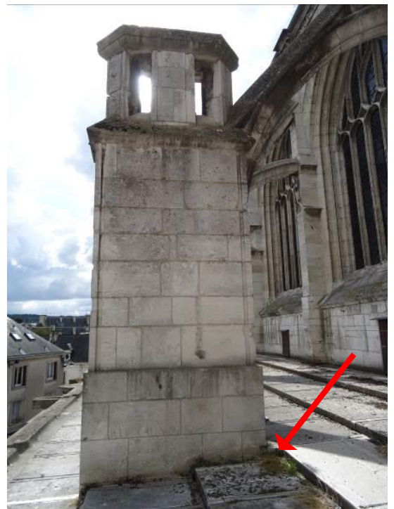
114. Joints ouverts dégradés, parements altérés et angles cassés de la culée.
