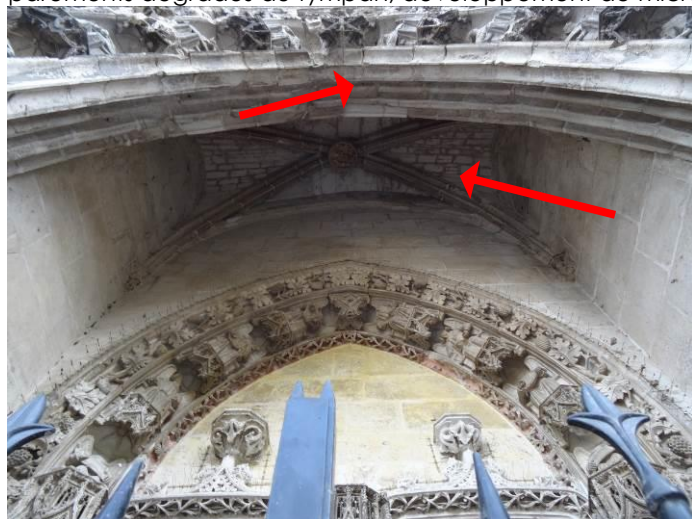
33. Portail Nord : joints dégradés au droit des voissures, voûte et murs.
