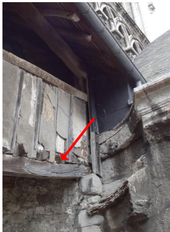
163. Passerelle : ossature bois et remplissage maçonné du pan de bois dégradés.
