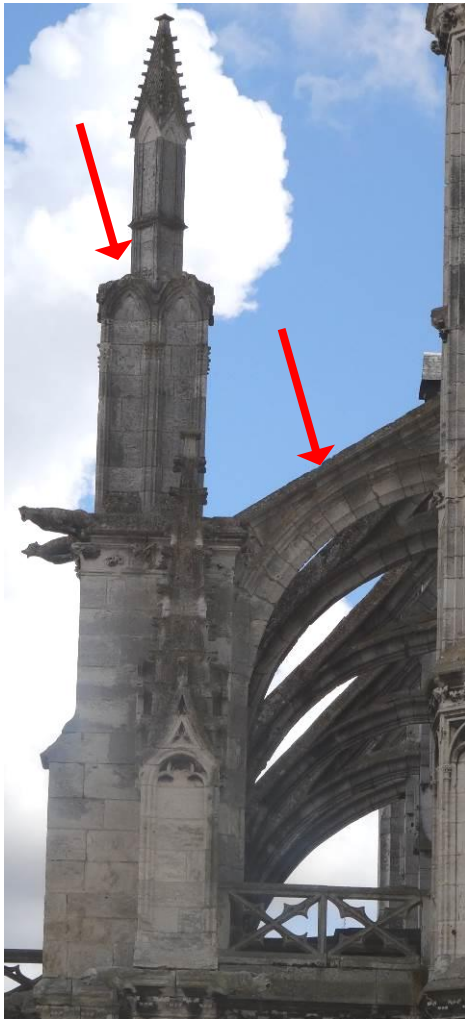
73. 1 er contrefort et arc-boutant Nord : encrassement généralisé, lacunes sur le pinacle.
