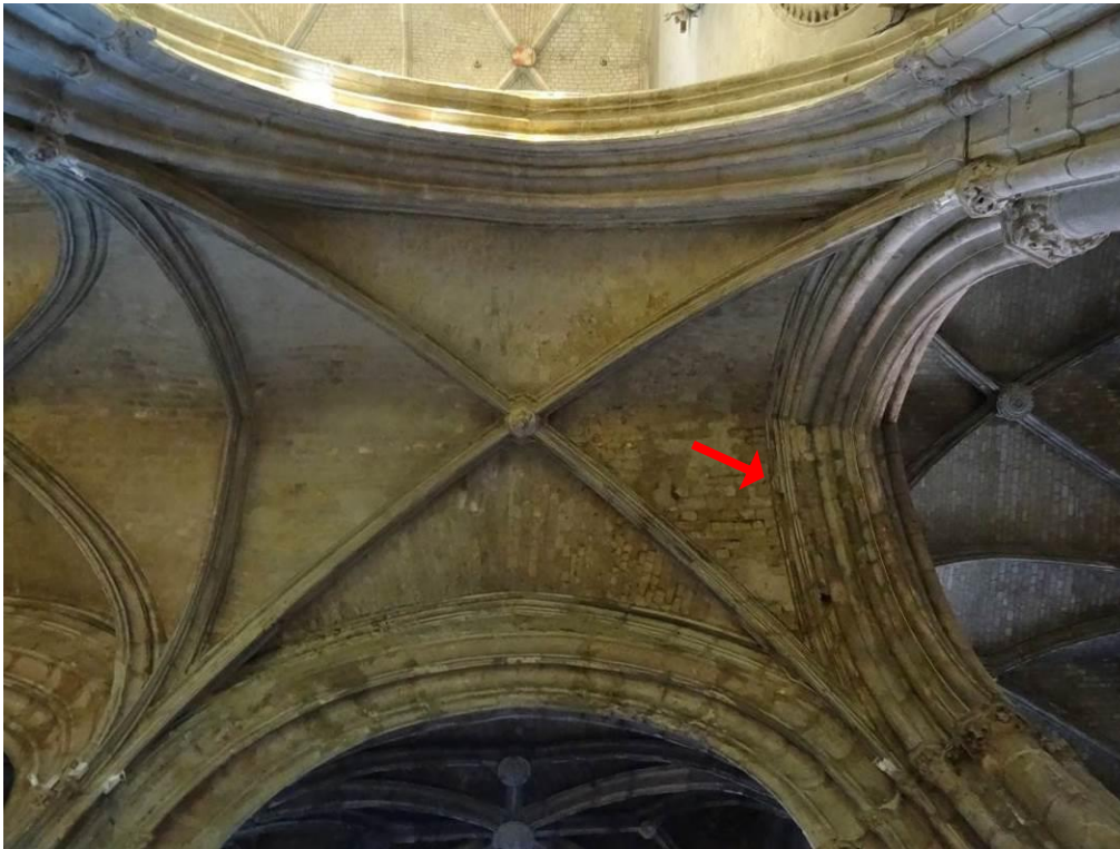
178. 6 ème travée du bas-côté Nord de la nef : encrassement généralisé, joints dégradés aux arcs, traces d'infiltrations d'eau sous voûte.
