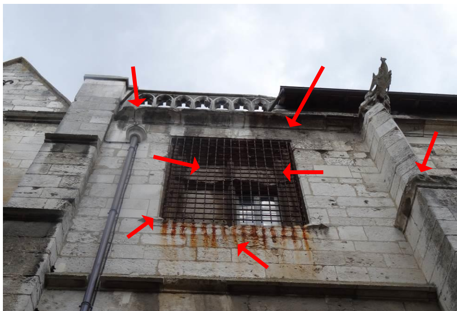
54. Joints ouverts au droit de la corniche, ruissellement des eaux sur parements, descente des eaux usée, grille corrodée, coulures de rouille sur les parements, appui de baie et larmier du contrefort épauprés.
