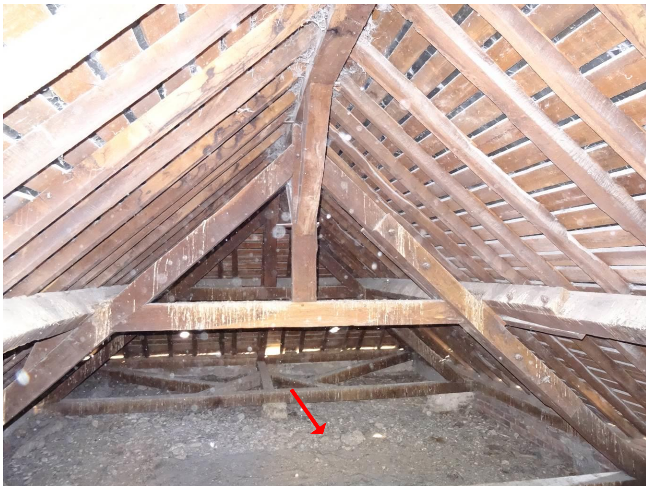
280 et 281. Combles de la sacristie : présence de fientes et traces de ruissellements des eaux.
