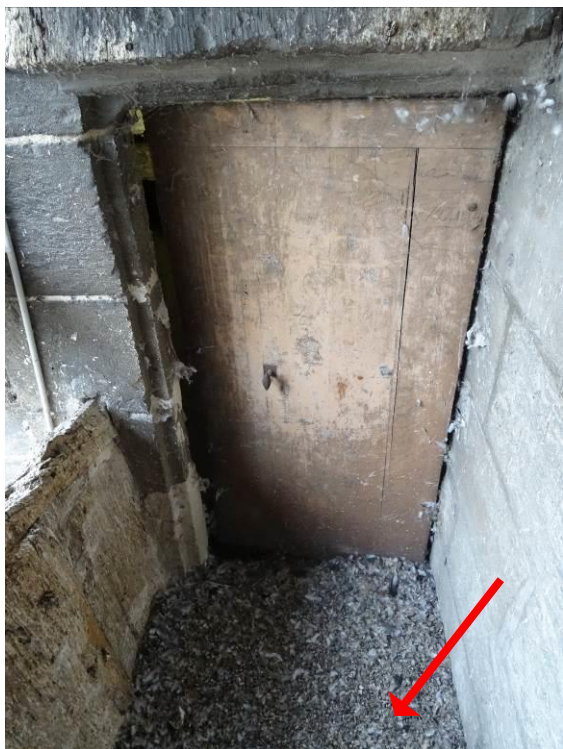
162. Platelage de passerelle couvert de fientes, porte bois accès escalier sacristie à bout d'usage.
