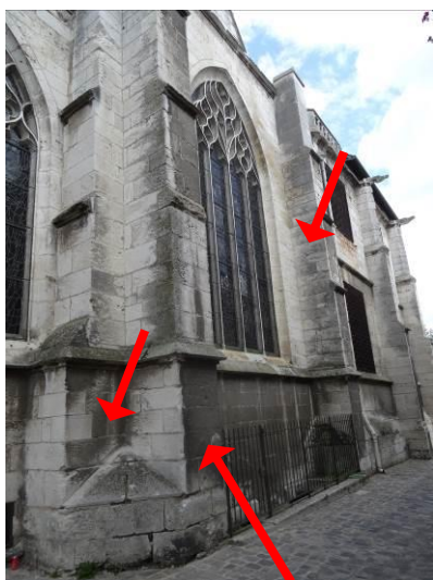
57. Encrassement du soubassement.
