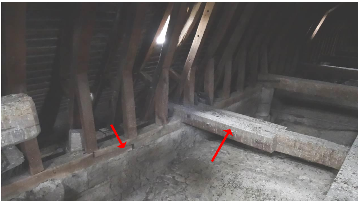
249. Combles de la nef : anciennes reprises en pied de ferme dégradées, sablières dé-assemblées.
