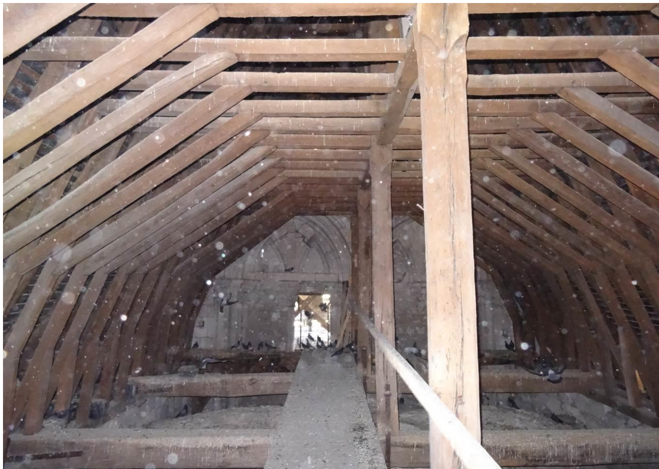
244. Comble de la nef : envahis et dégradés par les pigeons.
