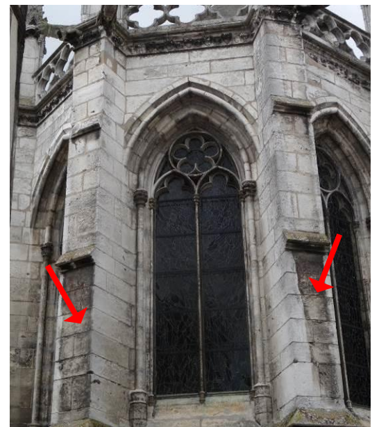
46. Chapelle axiale: encrassement des parements saillants des contreforts.
