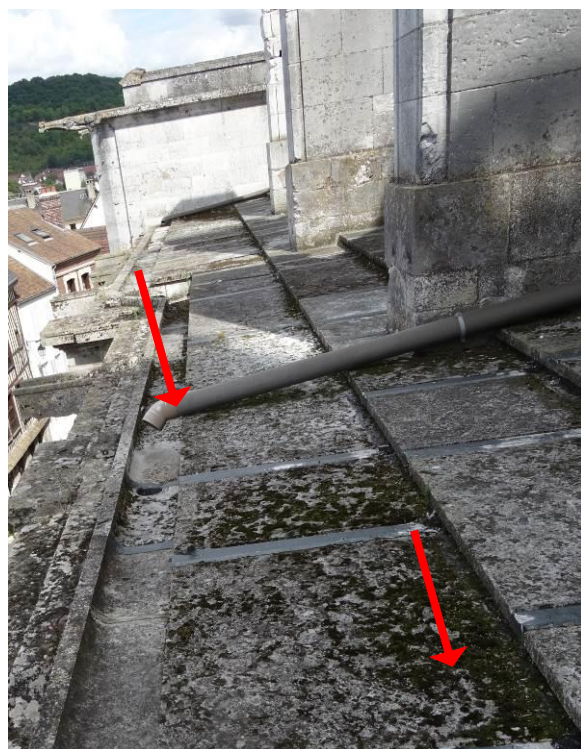
72. Terrasse Nord : descente EP usée, développement de micro-végétation sur les dalles et chéneaux en pierre.
