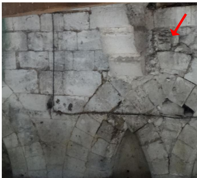
253 et 254. Combles de la tour de la croisée, niveau beffroi : ancienne reprise de l'entrait par gousset dégradée, maçonnerie désorganisée à l'arase du mur de la tour.
