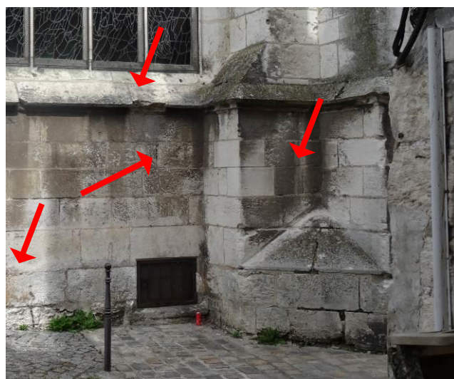
63. Encrassement et altération du soubassement, larmier épaupré.
