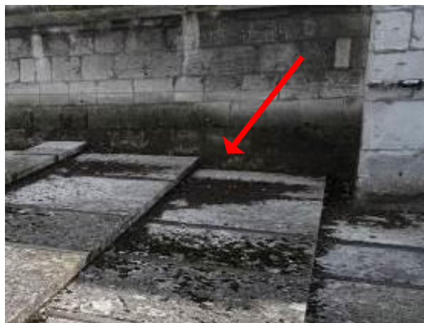
116. Bras Nord du transept : solin dégradé au pied de la tour de croisée.
