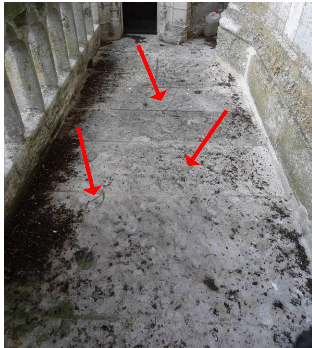
15. Détail du sol de la galerie haute sortant de la tourelle Nord : dalles de pierre fissurées parement dégradé.
