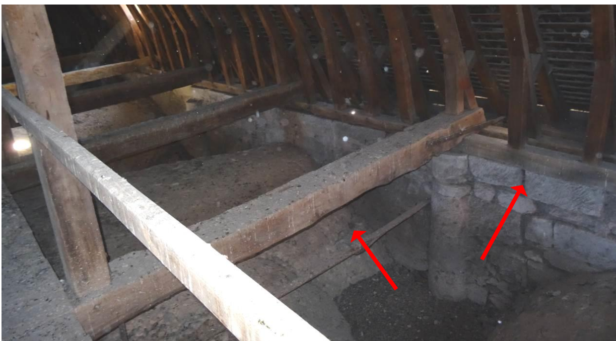
250. Tirant métallique et rein de voûte couverts de fientes, sablières déchaussées, arase désorganisée.
