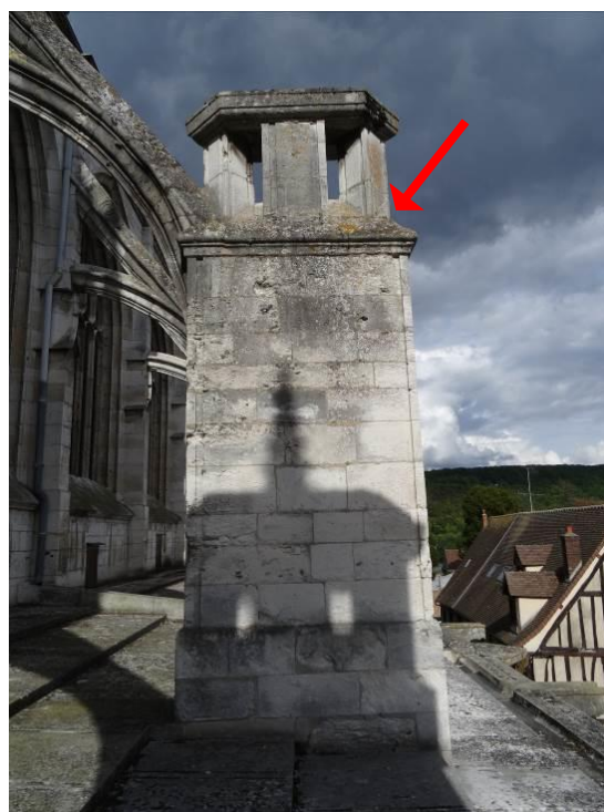
105. Joints ouverts dégradés, parements altérés et angles cassés de la culée.
