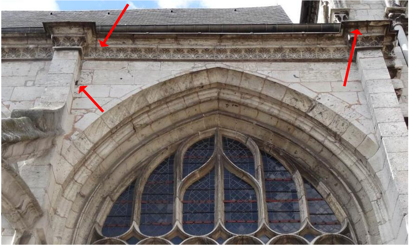
112. Encrassement généralisé, joints ouverts au droit de la corniche et du contrefort.
