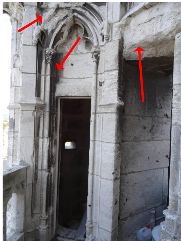
13. Détail de la porte d'accès à la galerie haute : de la tourelle Nord : parement dégradé, érosion des pierres de taille, joints ouverts, linteau entre la tourelle et le pignon largement érodé.
