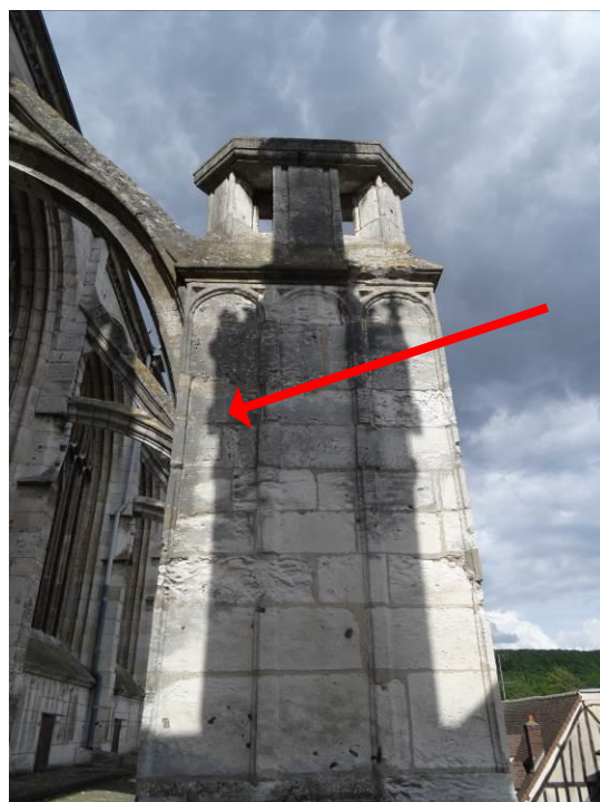
102. Joints ouverts dégradés, parements altérés et angles cassés de la culée.
