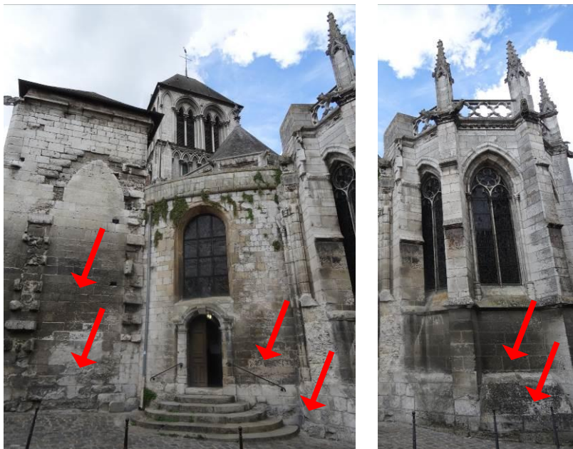
47 et 48. Encrassement et dégradation des parements en pied du mur de sacristie, traces de ruissellements d'eaux et développement de végétation au droit du déambulatoire et du portail Sud. Encrassement du soubassement de la chapelle axiale.
