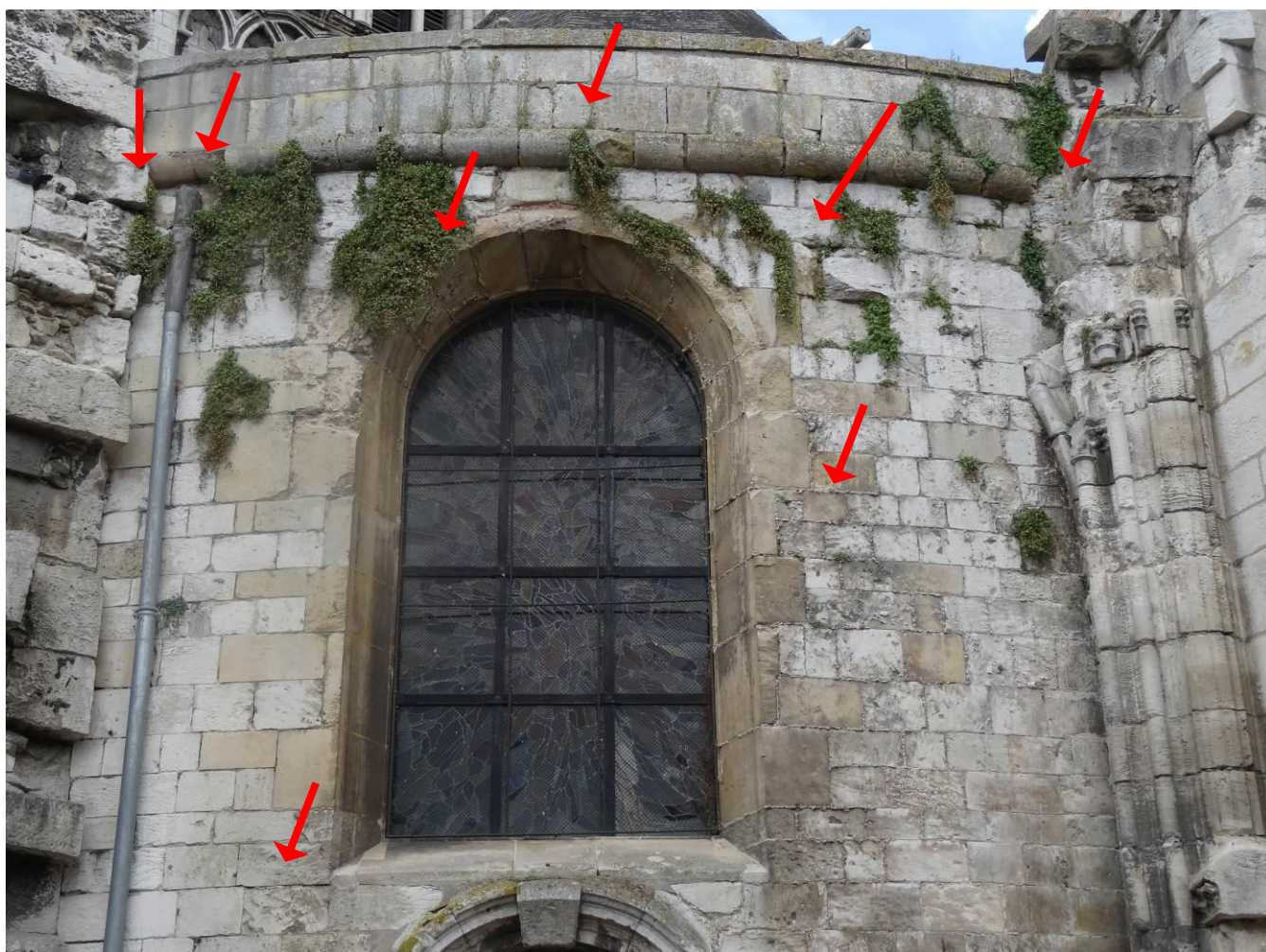
49. Parements et joints ouverts favorisant le développement de végétation. Boîte à eaux et descente EP à bout d'usage. Les arrachements des anciennes constructions sont altérés et érodés.
