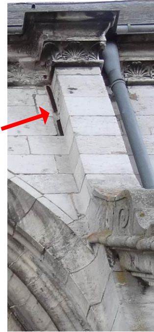
84. Ancre du tirant érodée.
