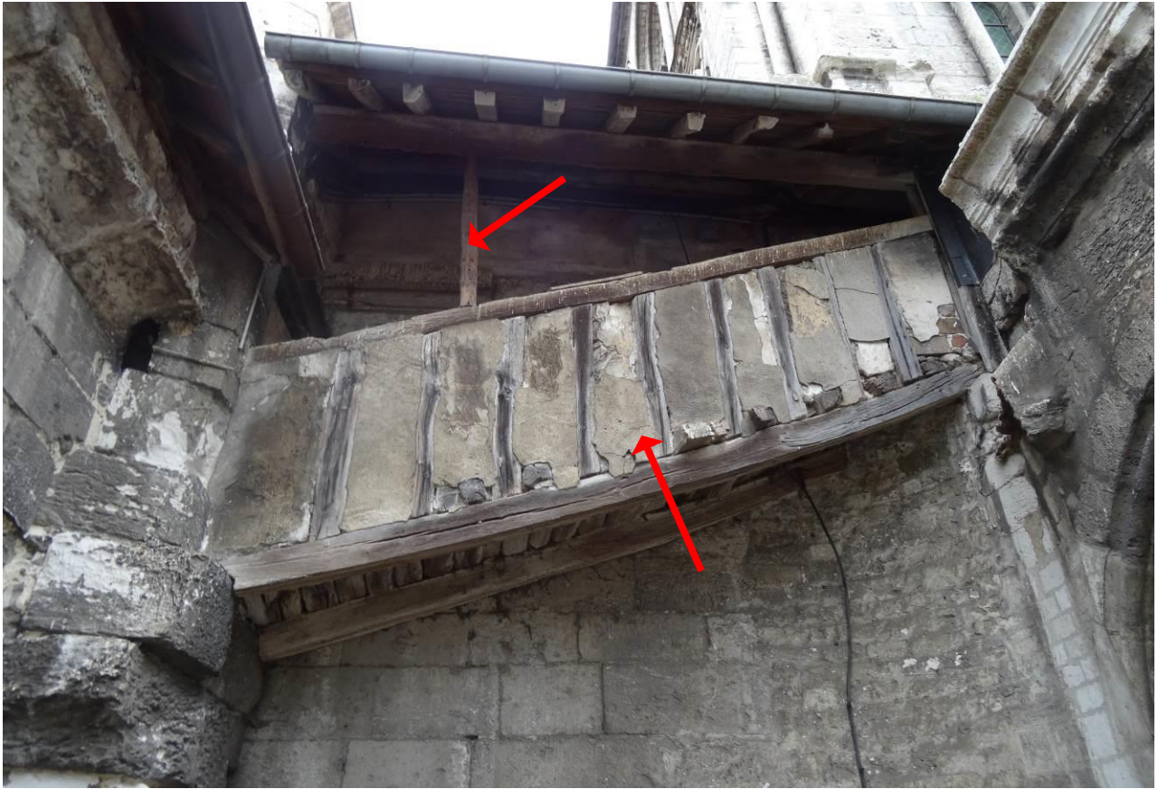
159. Passerelle entre sacristie et tour de la croisée : absence de clôture anti-pigeons, passerelle en pan de bois fortement dégradée, présence d'un potelet assurant étaieement appuyé sur la main courante, murs de la sacristie (gauche) et du chœur (droite) fortement dégradés, encrassement généralisé des parements.
