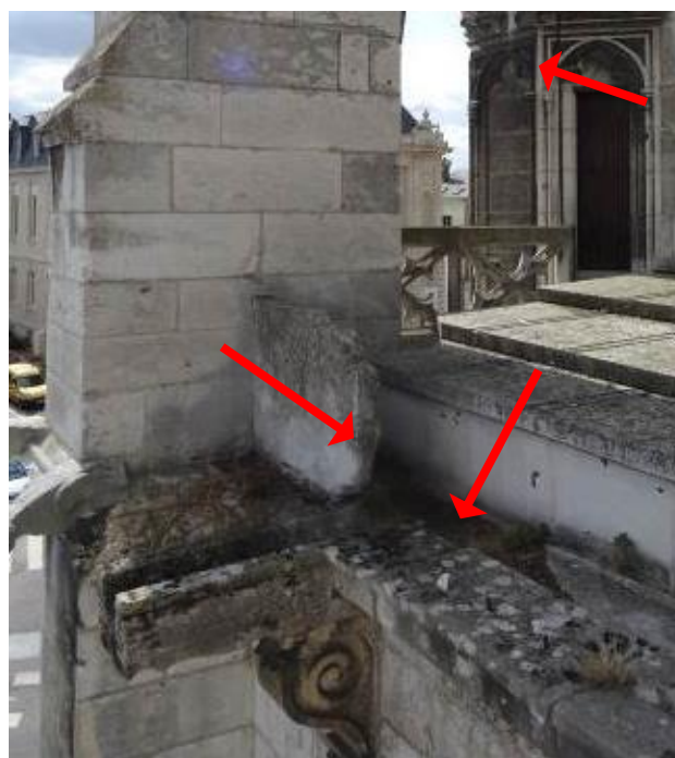
99. Terrasse Sud : encrassement des arcs boutants, développement de micro-végétation au droit des dalles de terrasse et du chéneau, absence de protection au vide.
