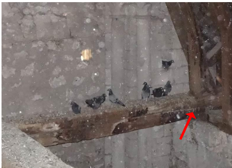
246. Anciennes reprises en pied de ferme dégradées.
