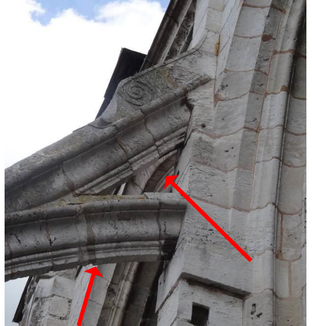
92. Joints ouverts et dégradés : arc-boutant désorganisé.
