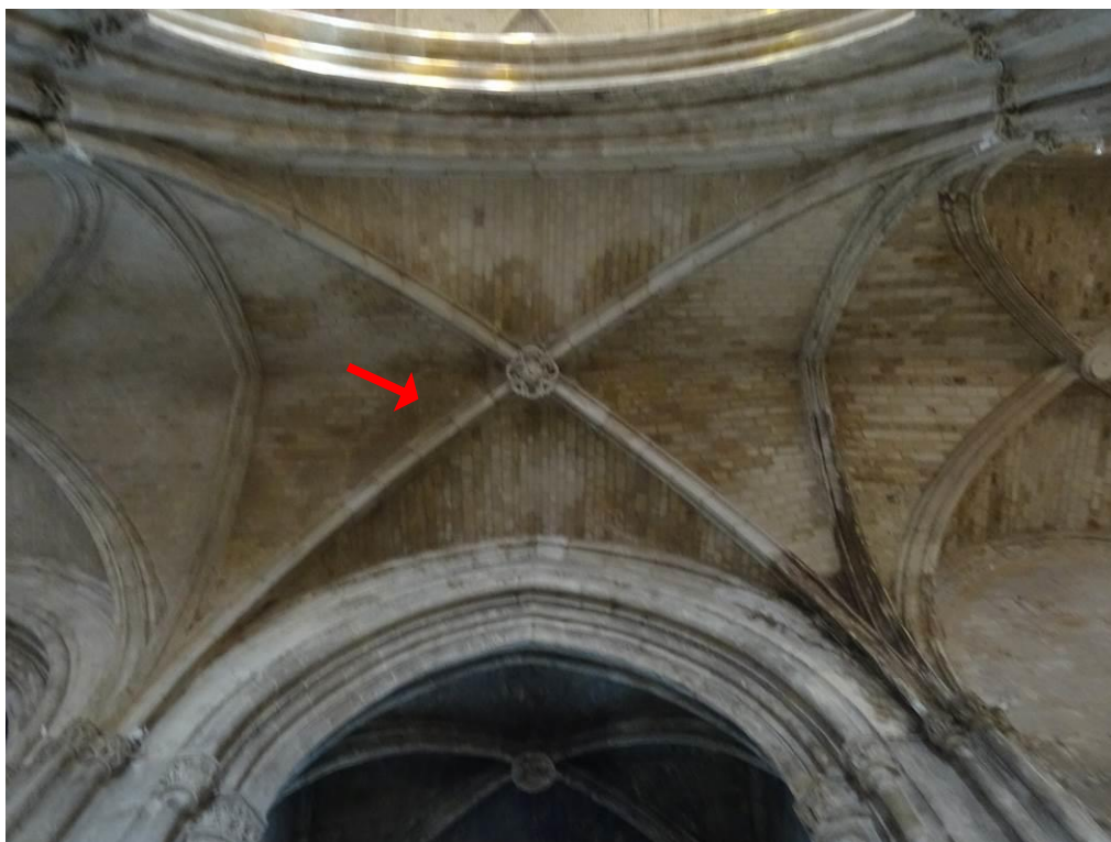
173. 3 ème travée du bas-côté Nord de la nef : joints dégradés et traces d'infiltrations d'eau sous voûte.
