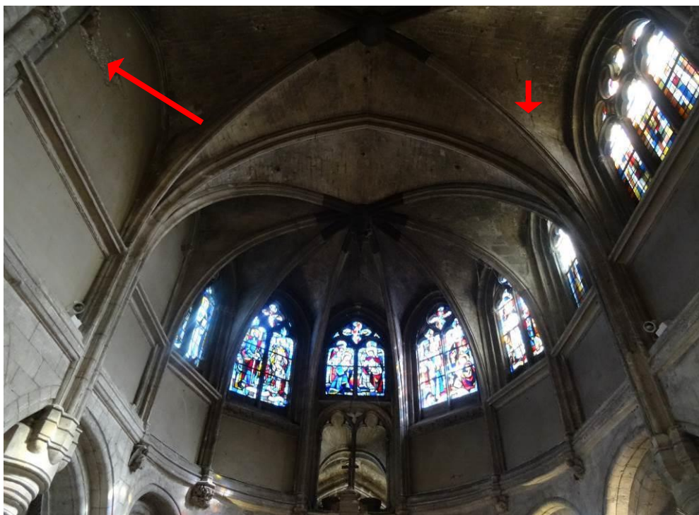
198. Chœur : encrassement généralisé, altérations des enduits, voutains fissurés par endroits.
