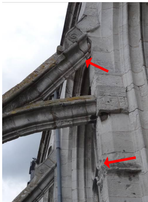
81. Joints ouverts et dégradés, entraînant la désorganisation de l'arc-boutant.
