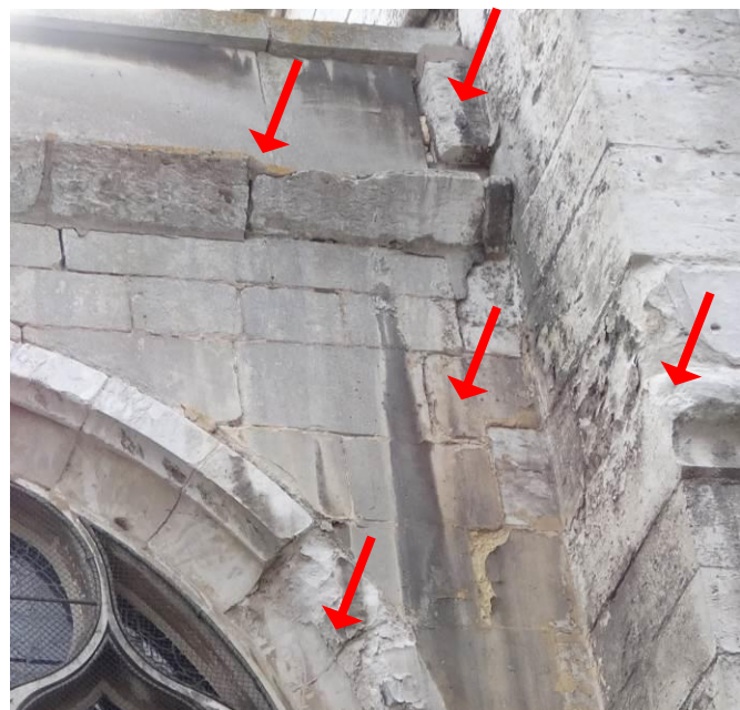
39. Traces d'infiltration d'eaux et dégradation des parements et joints entre deux chapelles Nord du déambulatoire, larmier épaupré, érosion de surface de certaines pierres de taille.
