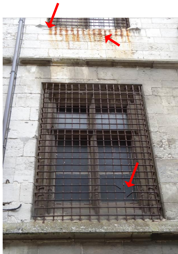
56. Bandeau d'appui de la baie haute érodé presque disparu, coulure de rouille sur façade, grille vétuste.
