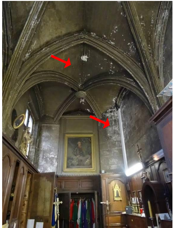
222. Intérieur sacristie : parements dégradés dus aux percements modernes pour assurer les passages de réseaux électriques.
