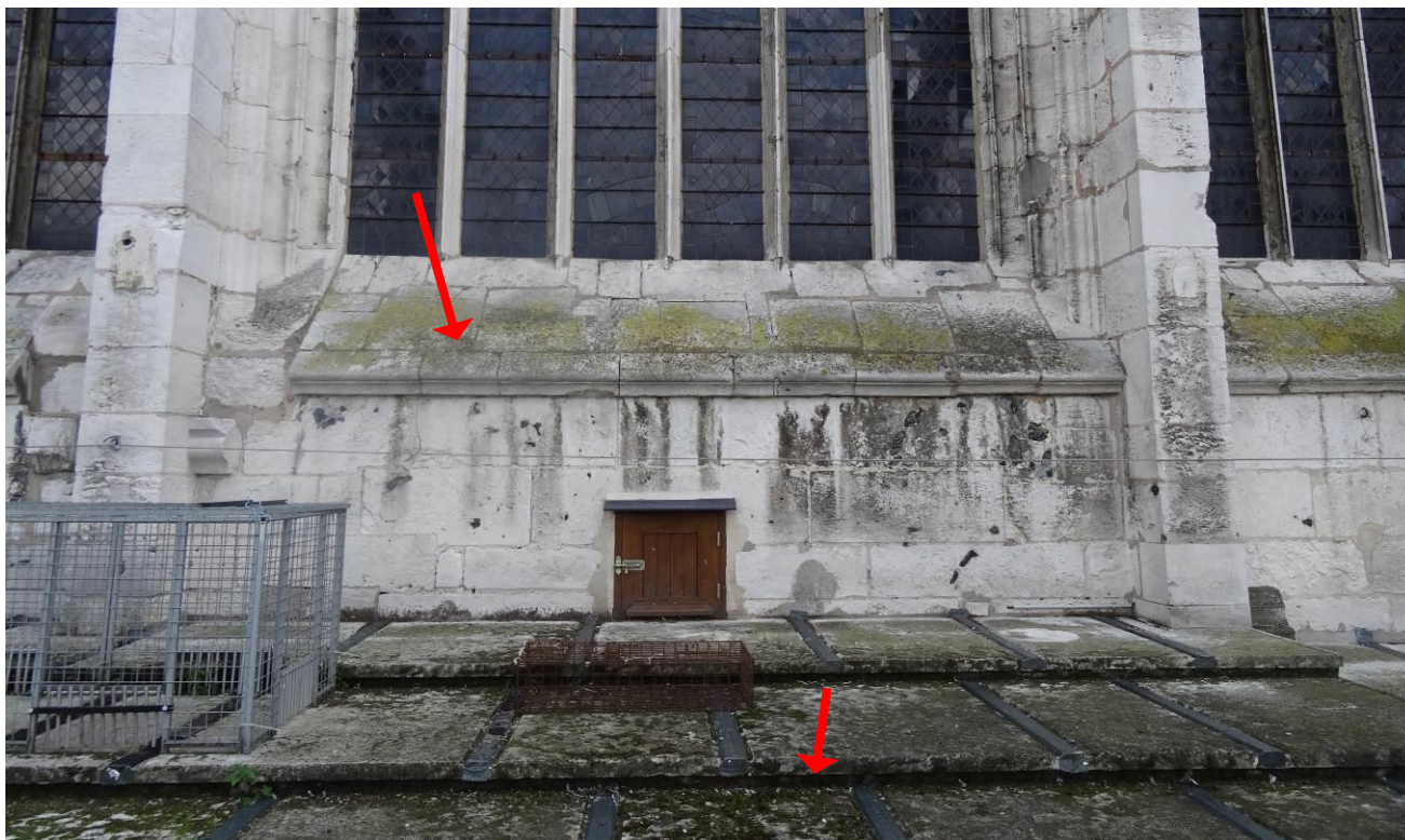
77. Développement de micro-végétation au droit des dalles de pierre et sur l'appui des baies hautes, couvre-joints en plomb dégradés.
