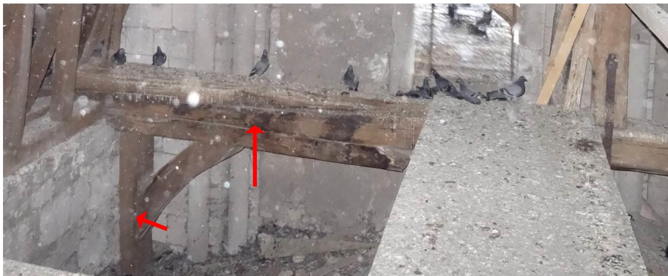
247. Combles de la nef : anciennes reprises en pied de ferme dégradées.
