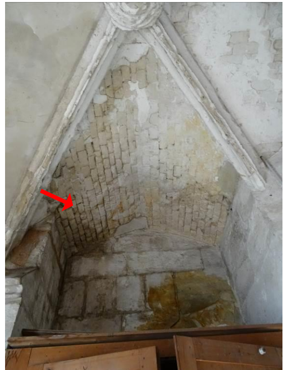
224. 1 er étage sacristie : joints dégradés, parements dégradés et chutes d'enduit dus aux infiltrations d'eaux.
