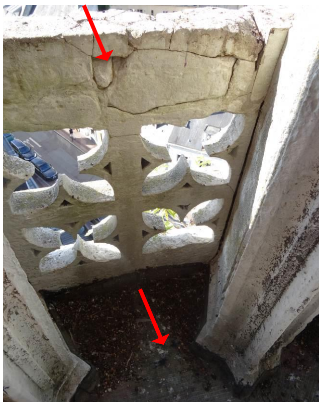
19. Détail de la balustrade au sommet de la tourelle Sud : pierre d'appui fissurée, sol de terrasse dégradé et couvert de fientes de pigeons.
