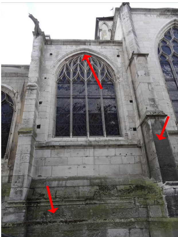
36. 1 ère chapelle Nord du déambulatoire (chapelle Sainte-Geneviève) : encrassement, joints dégradés, développement de micro-végétation sur le soubassement.
