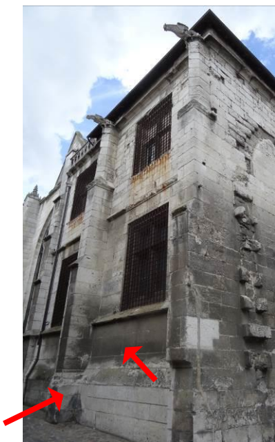
53. Encrassement et dégradation des parements de la façade Sud de sacristie.
