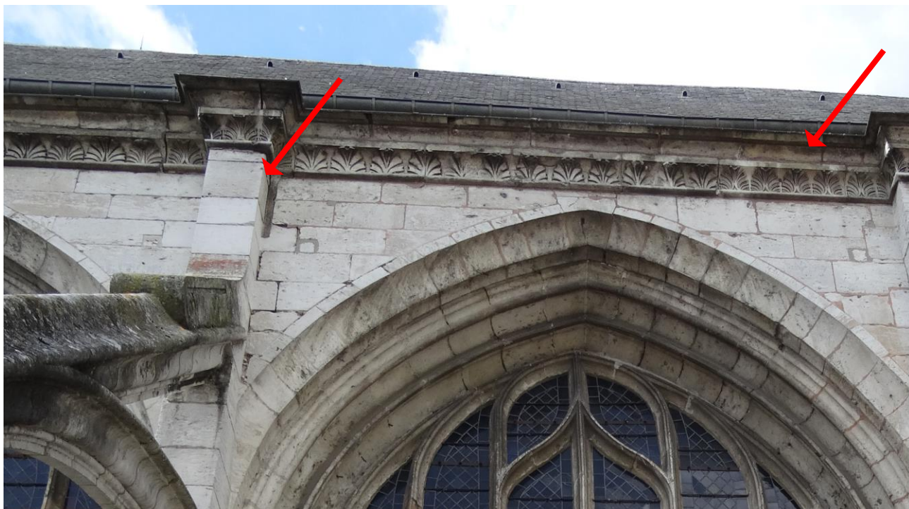
109. Encrassement généralisé, joints ouverts au droit de la corniche et du contrefort.
