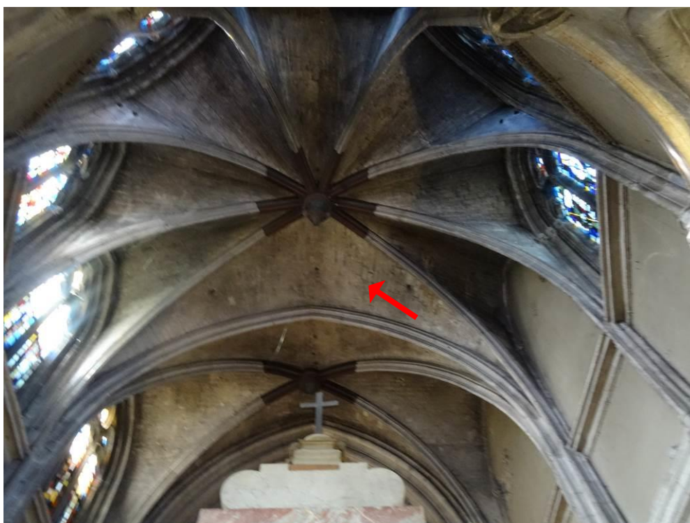
199. Chœur : encrassement généralisé, joints dégradés sur les voutains.
