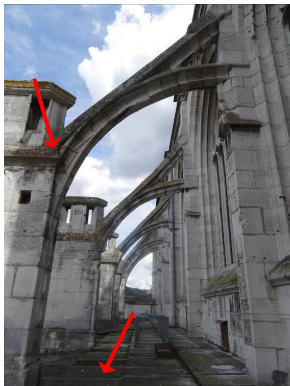
70. Terrasse Nord (vers l'Est) : encrassement des arcs boutants, développement de micro-végétation au droit des dalles de terrasse.
