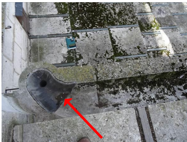
117. Bras Nord du transept : présence des fientes et micro-végétation au droit du chéneau.
