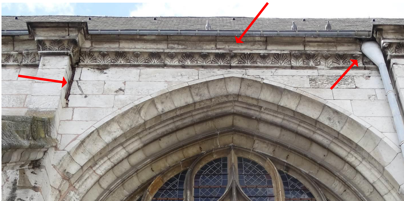
103. Encrassement généralisé, joints ouverts au droit de la corniche et du contrefort.
