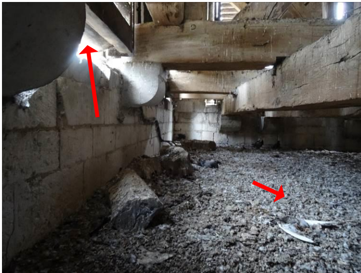
255 et 256. Combles de la tour de la croisée, niveau beffroi : ossature du beffroi fortement dégradée par les fientes, abat-sons vétustes laissant pénétrer les pigeons.
