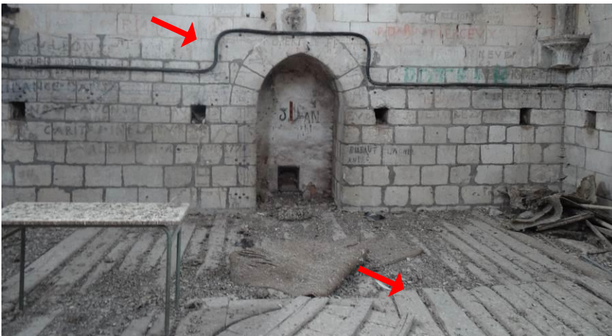
225, 226 et 227. Elévations Ouest de la chapelle haute (croisée du transept) : encrassement généralisé, volume dégradé par pigeons, voûte enduite dégradée et fissurée, présence de fissures sur reprises aux angles Sud-Ouest et Nord-Ouest, joints dégradés au mur, plancher dégradé par fientes, installation électrique vétuste, présence des nombreux graffitis.
