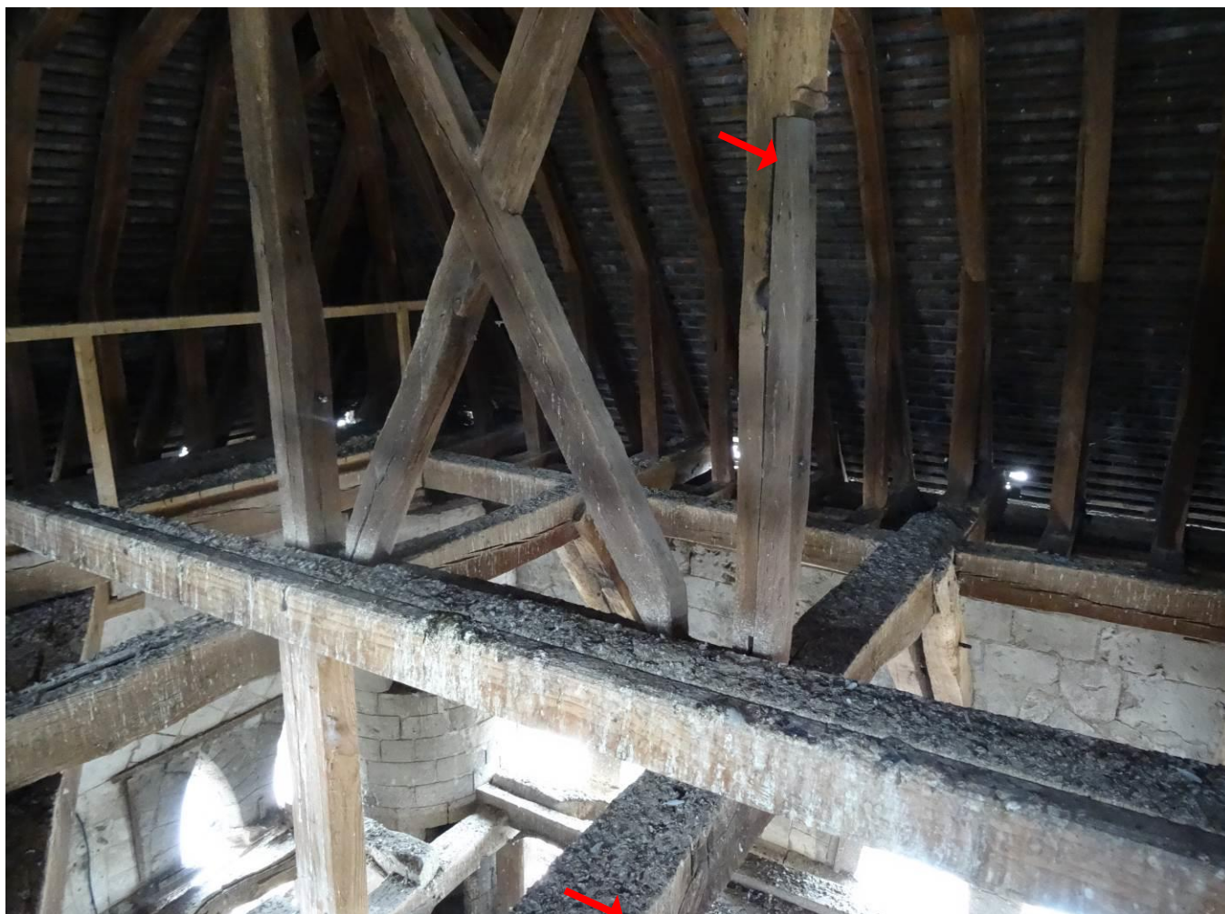
257. Comble de la tour de la croisée : charpente dégradée par les fientes, ancienne reprise de poinçon dégradée.
