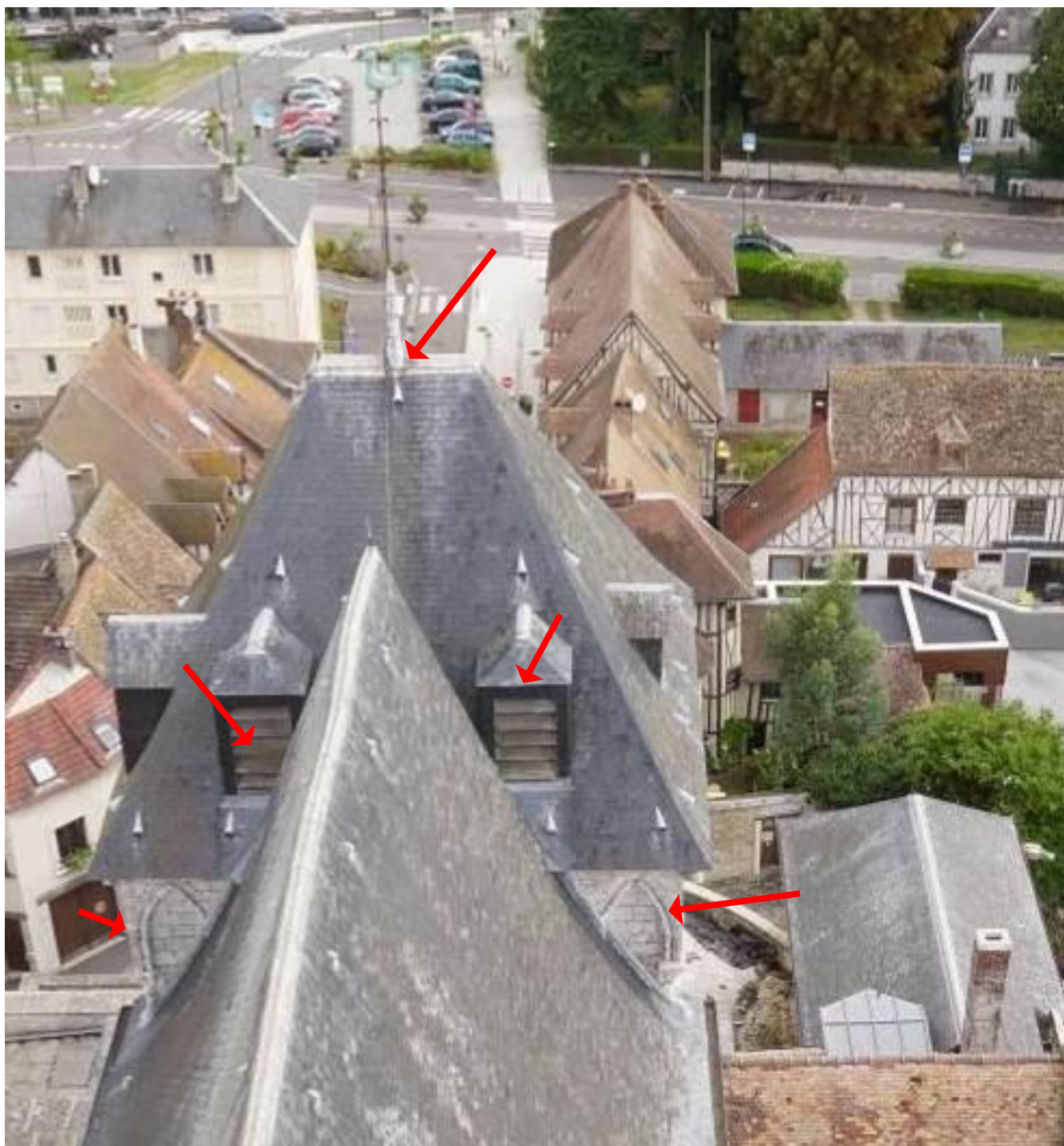
128. Façade Ouest et toiture de la tour de croisée : encrassement généralisé, joints ouverts et dégradés, vieillissement de la toiture en ardoise, compris fenêtres de toit, le faîtage. Epi du toit et la girouette coq en plomb à bout d'usage.
