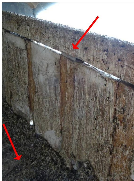
165. Main courante de la passerelle couverte de fientes : forte dégradation.
