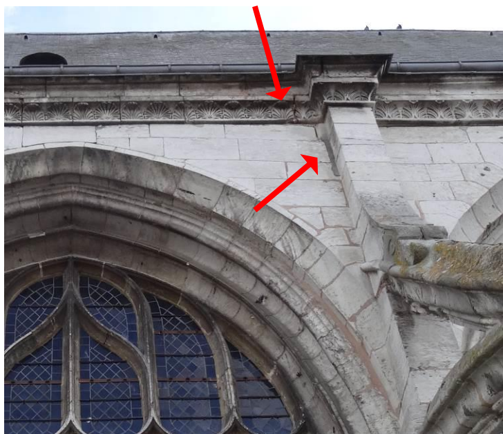
80. Encrassement généralisé sur élévation, joints ouverts sur la corniche et au droit du contrefort au niveau de l'ancre du tirant.
