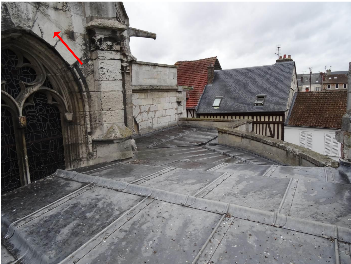
142. Terrasse Est du déambulatoire (côté Est) : parements encrassés, terrasse en plomb couverte par endroit de fientes
