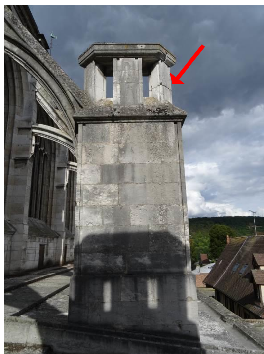
108. Joints ouverts dégradés, parements altérés et angles cassés de la culée.
