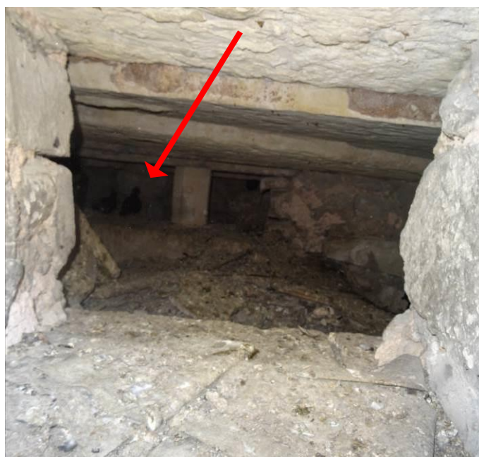
151. Vide entre la toiture en plomb et l'extrados de chapelle axiale : dégradation et envahissement par les pigeons faute de fermeture.
