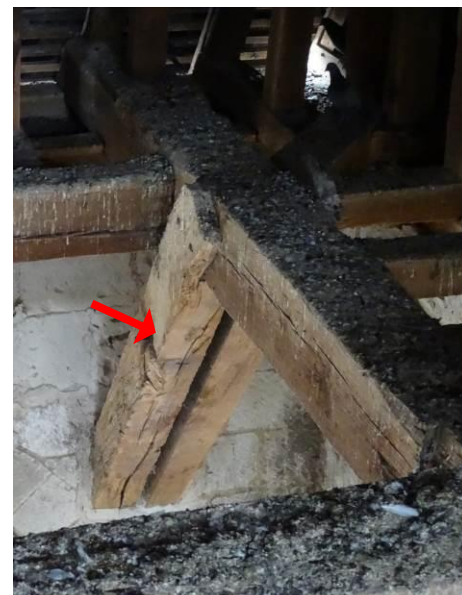
259. Entrait moisé par deux jambes de force dégradées.
