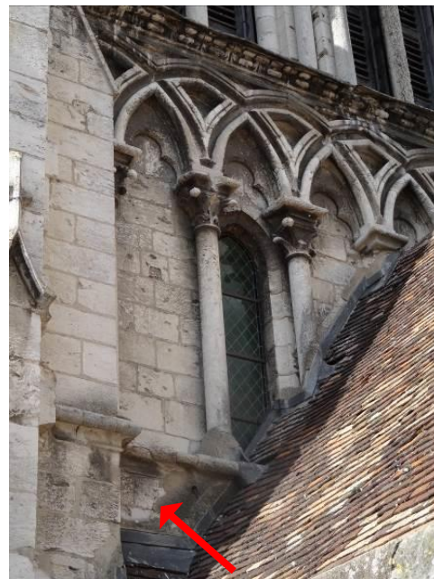
121. Bras Sud du transept : solin dégradé.
